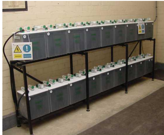
Figura N° 17: Conjunto de baterías.
