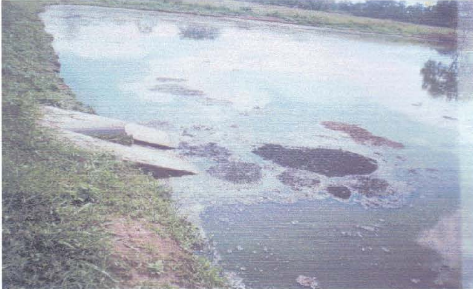
Foto 03. Acumulación de lodos en el ingreso de las lagunas
