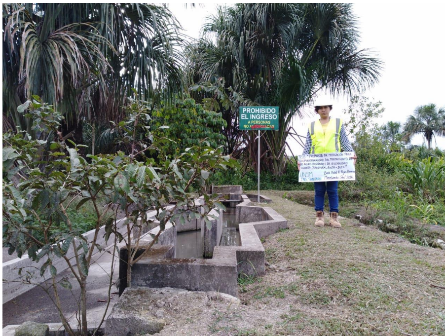
Fotografía 1. Entrada de aguas residuales a la cámara de rejas.
