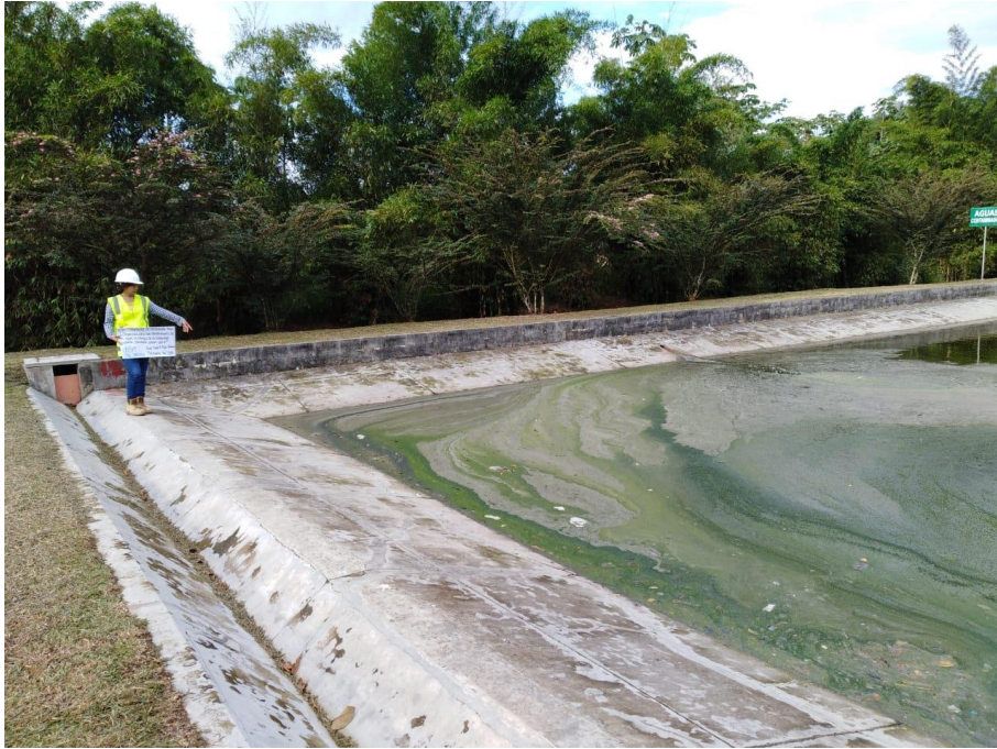
Fotografía 3. Laguna facultativa primaria.
