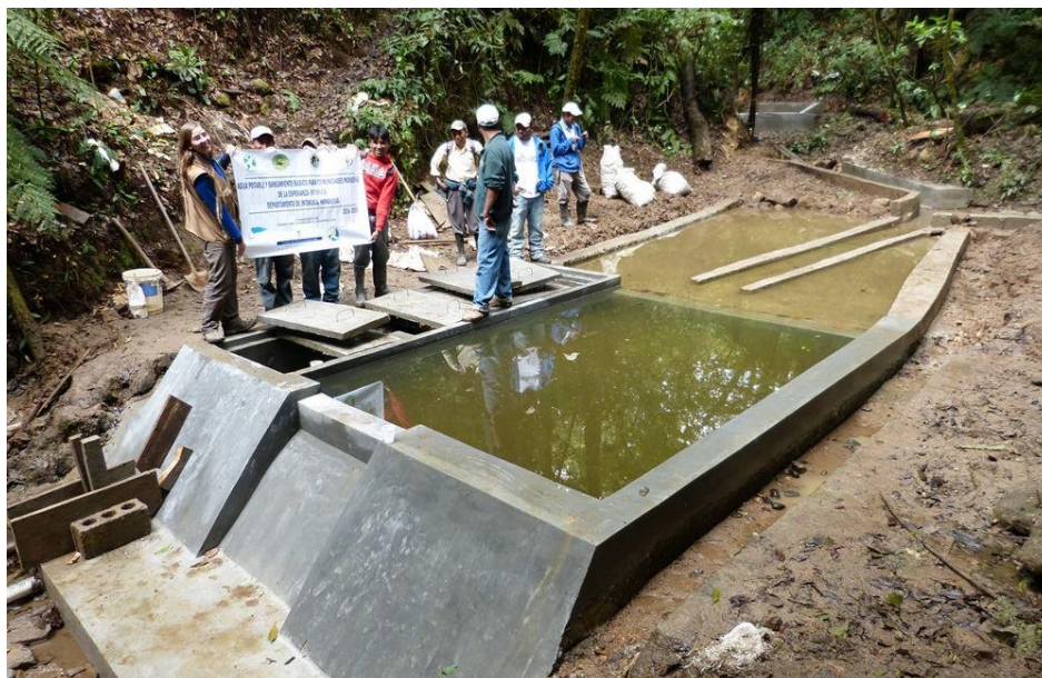
Imagen 13: Vista de captación de agua para comunidad rural. (Fuente: Geologosperu.pe)
