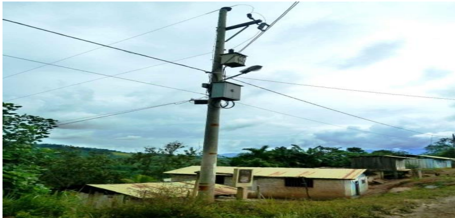
Imagen 15: Transformador en zona rural para abastecimiento de energía eléctrica.
