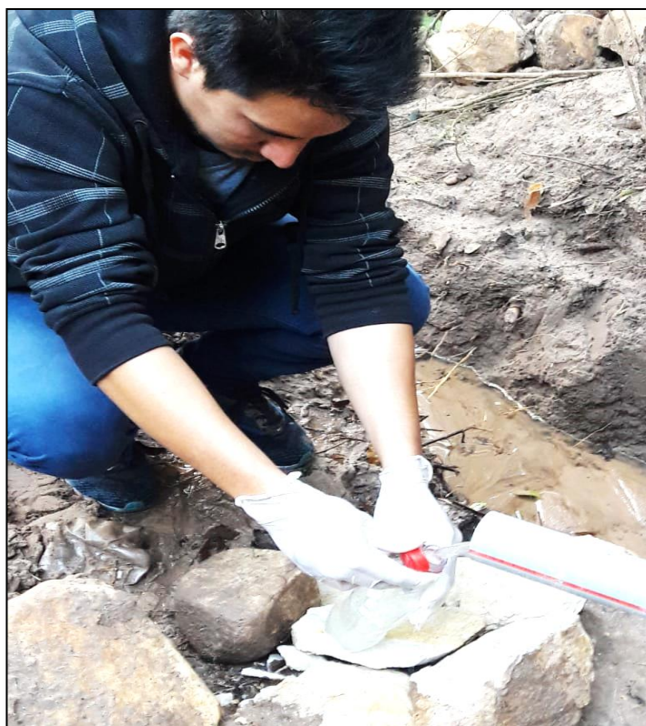
Fotografía 14. Toma de muestra a la salida del filtro.
