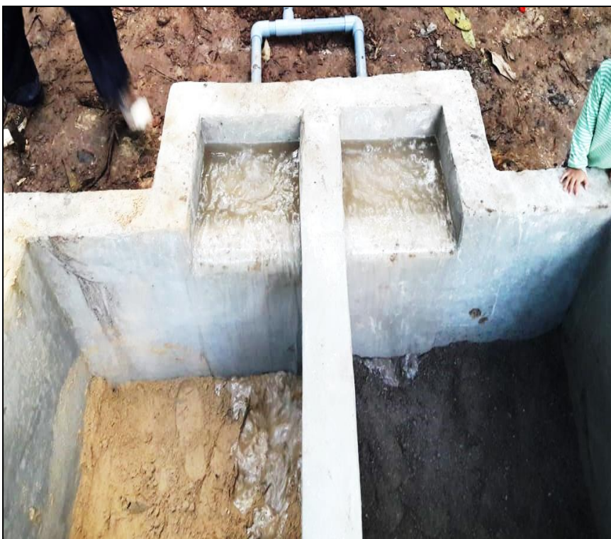
Fotografía 12. Llenado de los filtros con aguas de la quebrada La Oyada.
