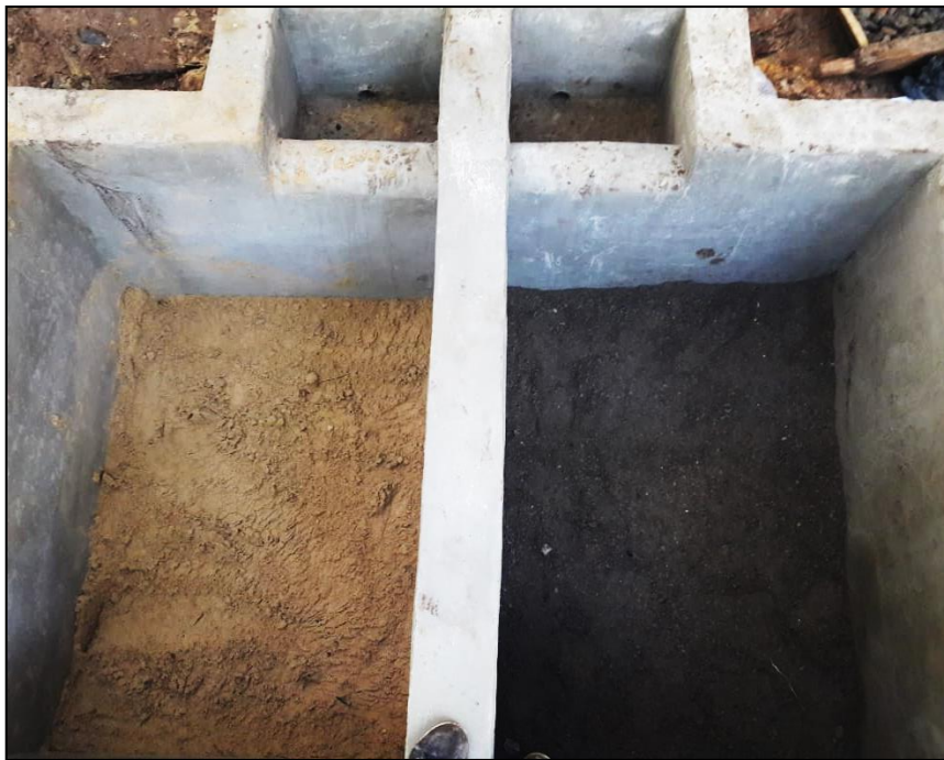
Fotografía 11. Filtros listos para su funcionamiento.
