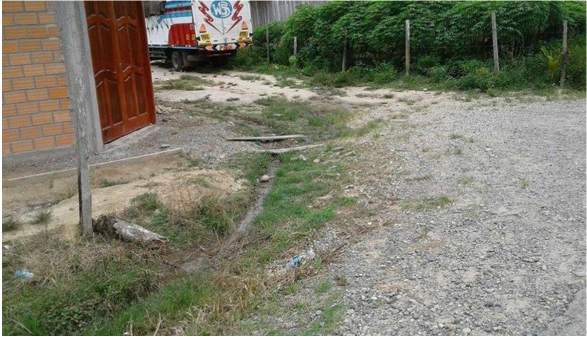
Figura 23. En la imagen se aprecia las cunetas construidos empíricamente por los pobladores ubicados en los jirones. Amazonas cruce con Jr. San Juan ( Fuente: Elaboración propia)
