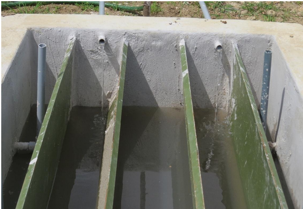
Fotografía 5. Distribución del afluente en el tanque imhoff
