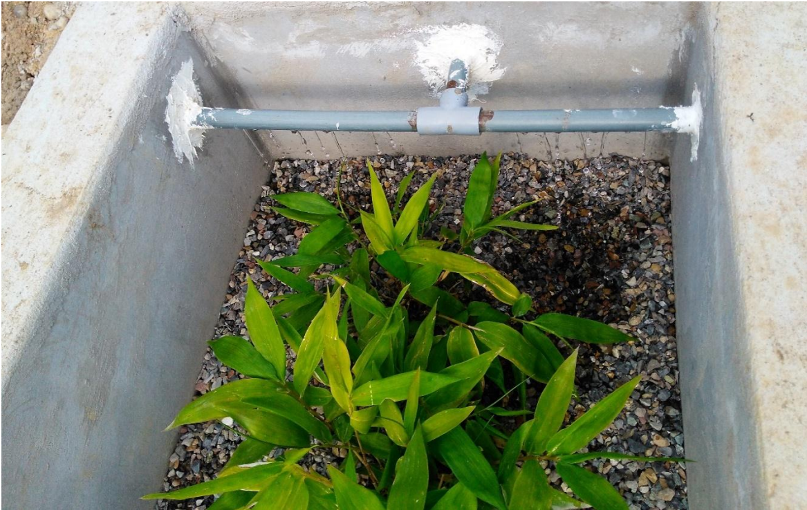
Fotografía 6. Distribución del agua residual al humedal artificial luego del tanque imhoff.
