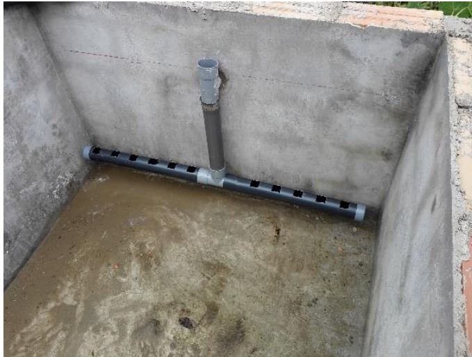
Fotografía 7. Accesorios sanitarios a la salida del humedal artificial
