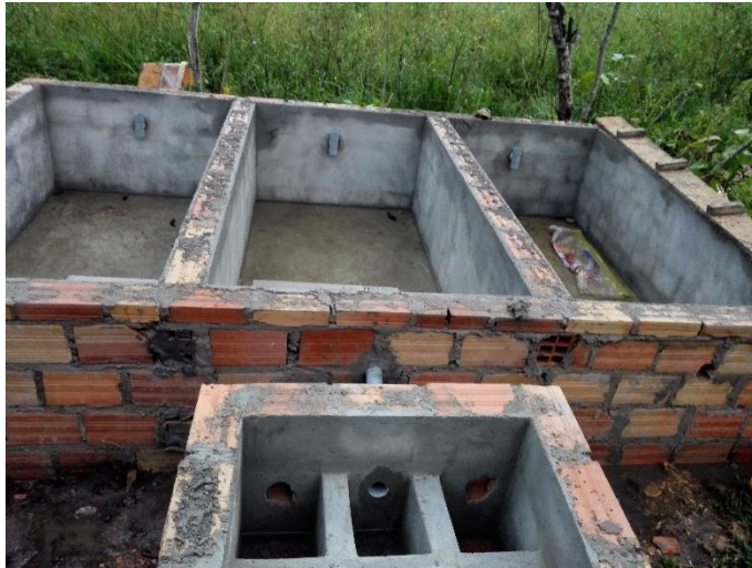
Fotografía 4. Sistema de humedales
