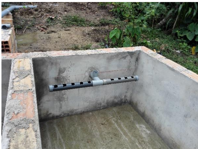
Fotografía 6. Accesorios sanitarios a la entrada del humedal artificial
