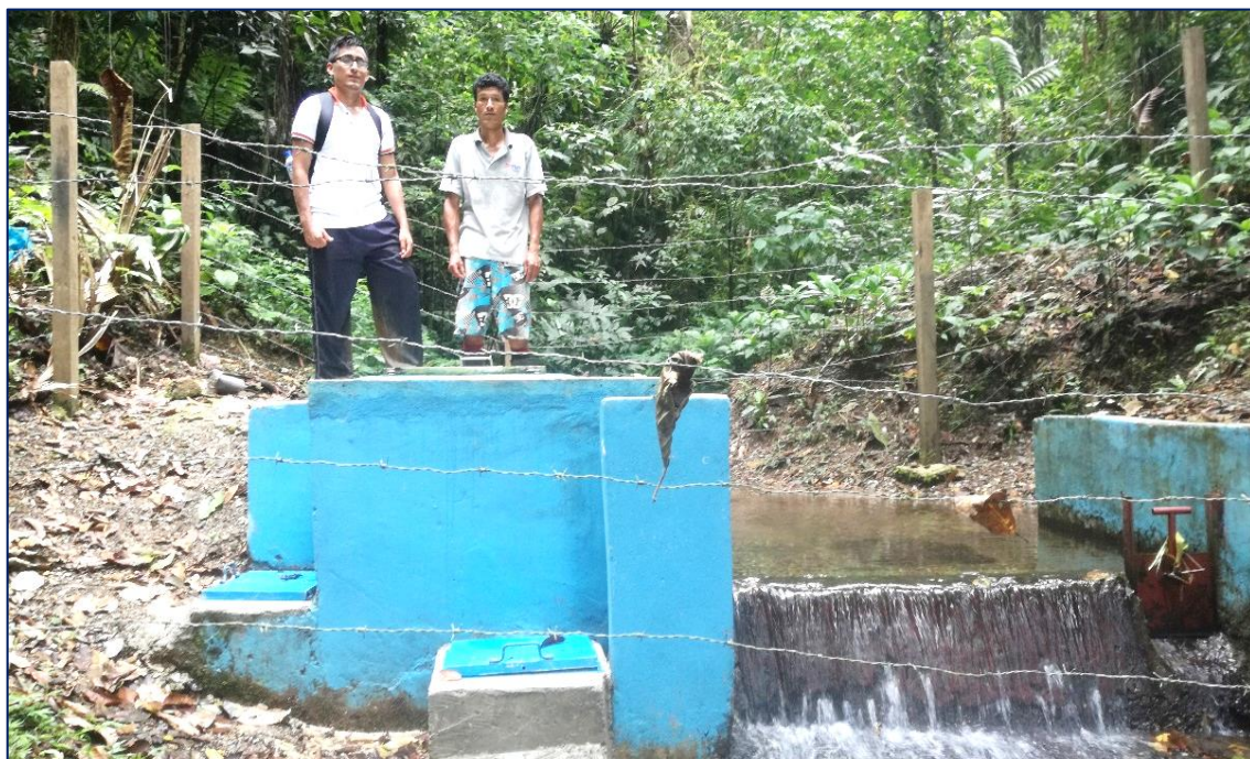
Fotografía 3. Verificación del estado de la captación de agua del centro poblado Nueva Santa Cruz.
