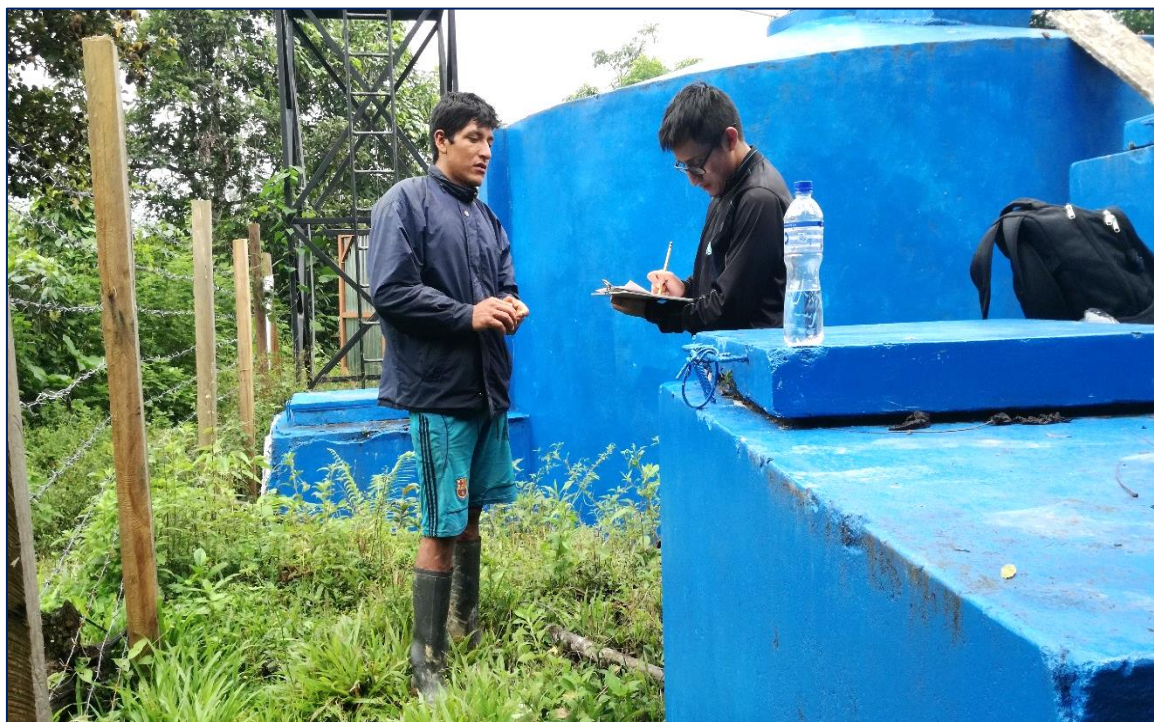
Fotografía 5. Verificación del sistema de cloración del centro poblado San Carlos
