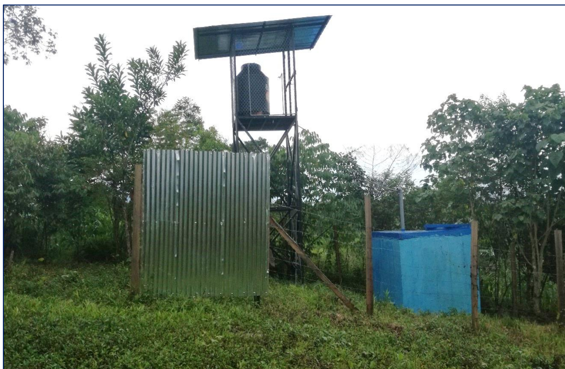
Fotografía 10. Verificación del sistema de cloración del centro poblado Alto Mayo
