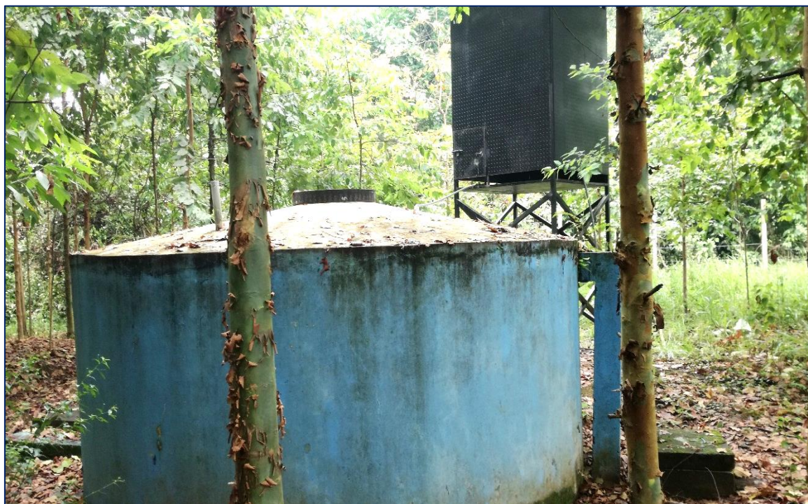
Fotografía 7. Verificación del sistema de cloración del centro poblado Shampuyacu
