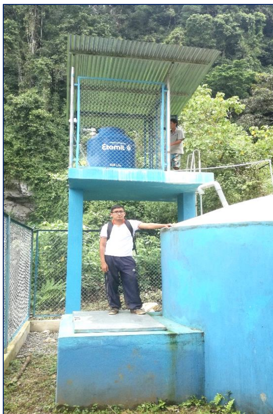
Fotografía 1. Verificación del sistema de cloración del centro poblado Nueva Santa Cruz
