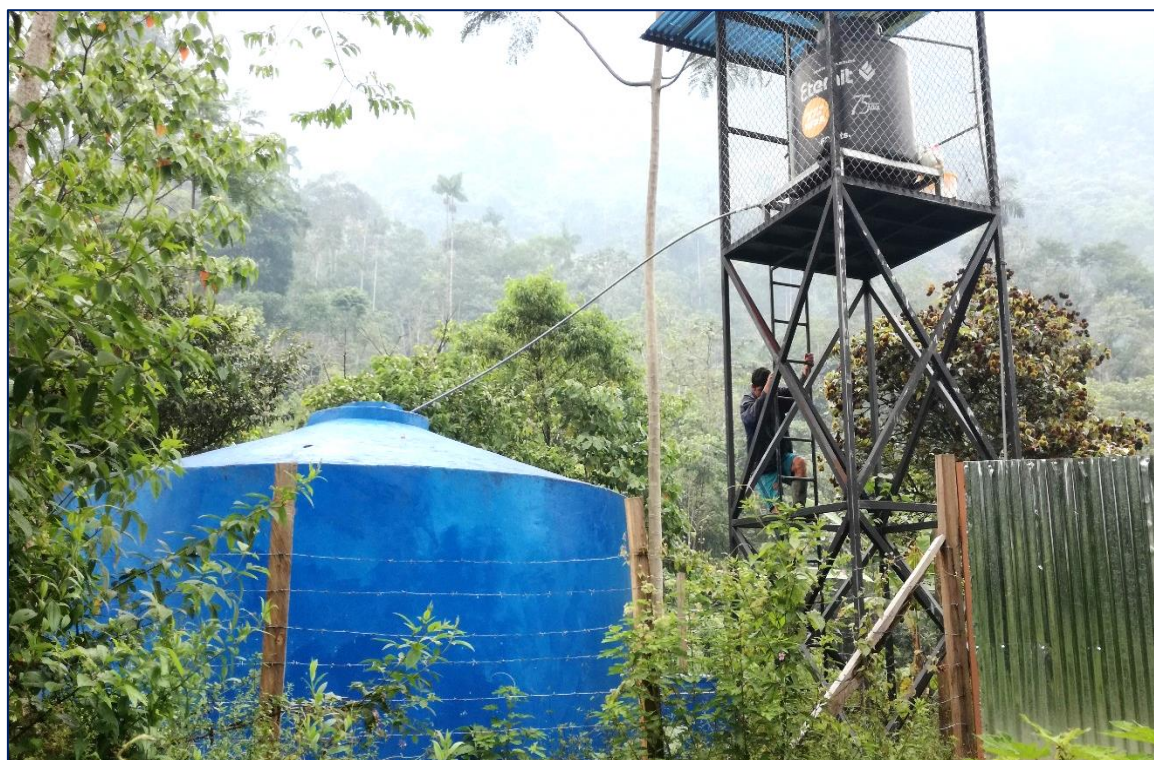
Fotografía 4. Verificación del sistema de cloración del centro poblado San Carlos.
