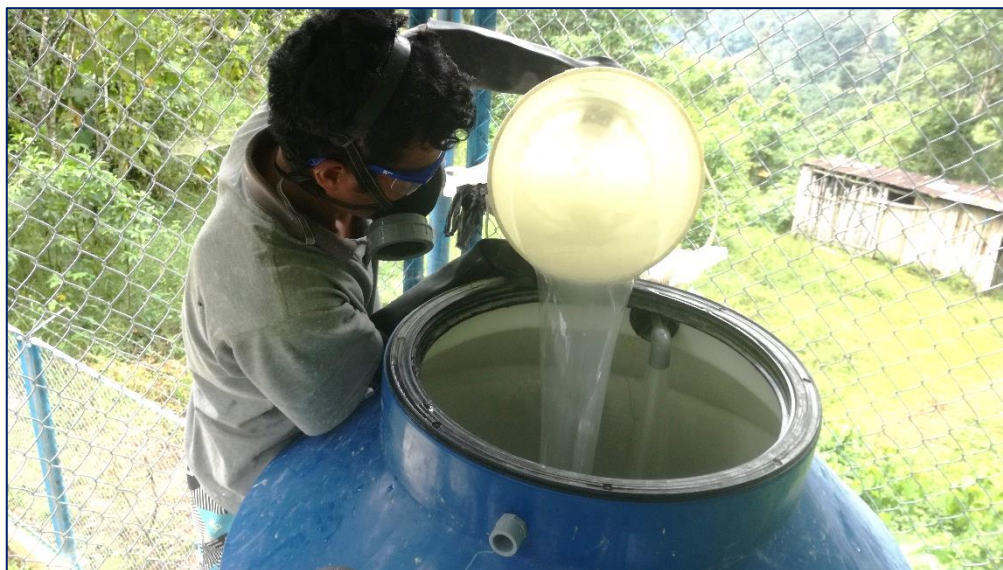
Fotografía 2. Realización de la mezcla de la solución madre en el sistema de cloración del centro poblado Nueva Santa Cruz
