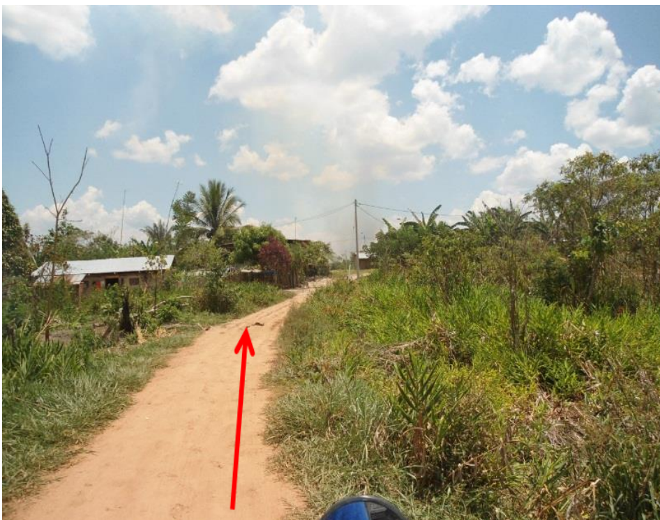
Fotografía N°02: Se aprecia la erosión del ancho de plataforma, donde existen baches, convirtiéndose en Zona Inundable, será necesario la construcción una Alcantarilla HDPE Long.=11.00m, d=42", (km 00+140.00), Zona Crítica.
