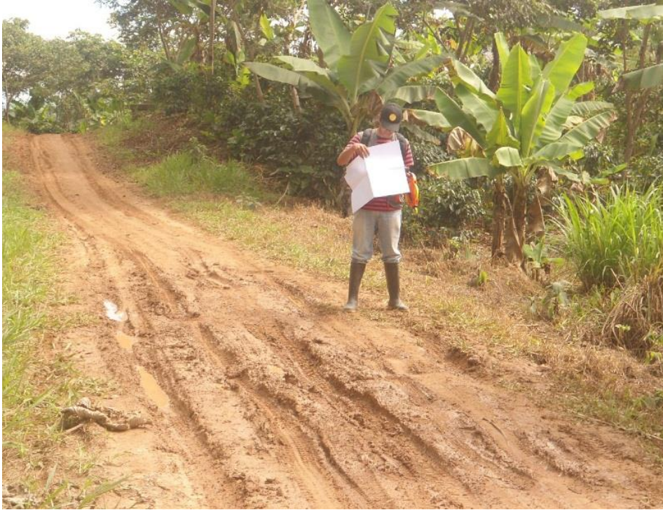
Fotografía N°03: Se aprecia la erosión del ancho de plataforma con baches y encalaminados, será necesario la construcción de una Alcantarilla HDP. Long.=8.00m, d=36", (km 00+503.00), Zona Agrícola.
