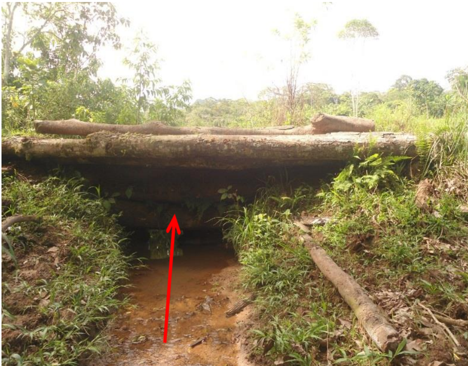
Fotografía N°04: Se muestra el Cruce provisional de madera en estado regular (Zona Inundable, en épocas de lluvia), será necesario la construcción de una Alcantarilla HDPE d=60" (2 ojos), Long.=10.00m (Km 1+566.00).
