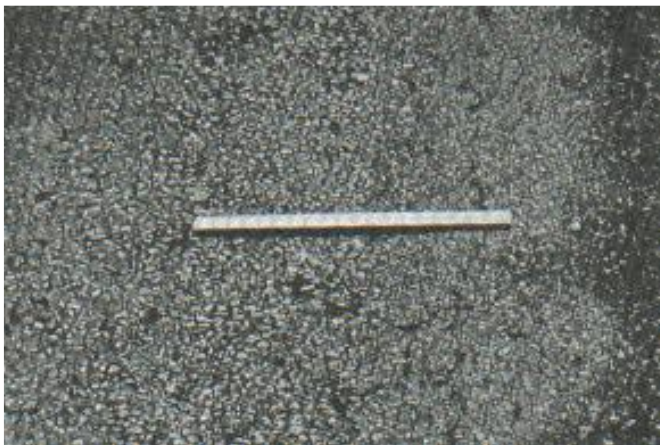
Figura 65. Meteorización y/o desprendimiento de agregados con nivel de severidad bajo o leve (Fuente: Vásquez (2002))
