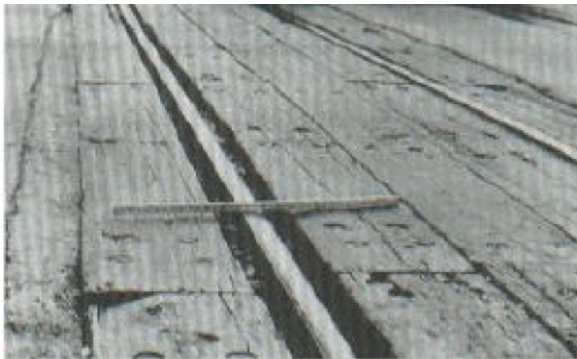
Figura 53. Cruce de vía férrea con nivel de severidad media (Fuente: Vásquez (2002))
