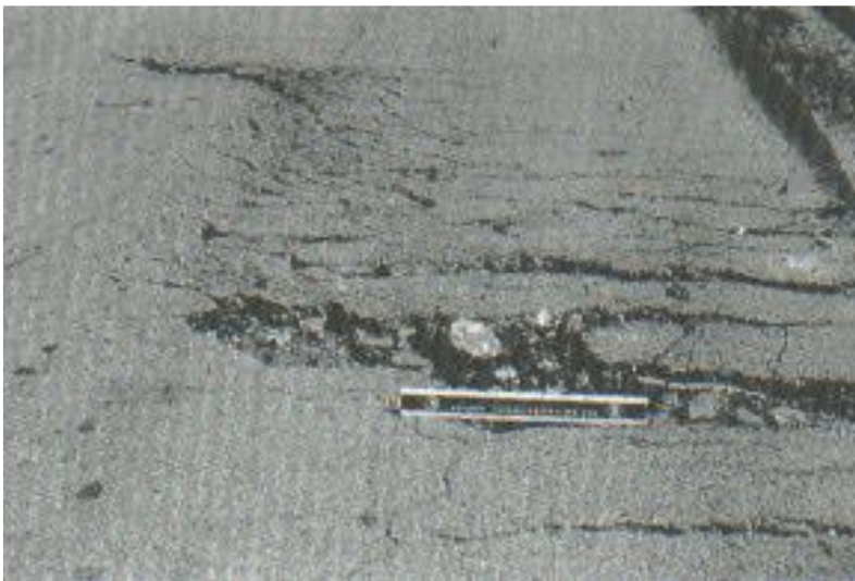
Figura 63. Grietas parabólicas con nivel de severidad alta (Fuente: Vásquez (2002))
