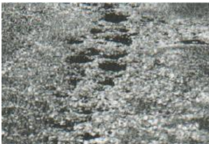
Figura 67. Meteorización y/o desprendimiento de agregados con nivel de severidad alta (Fuente: Vásquez (2002))
