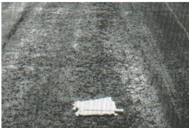
Figura 66. Meteorización y/o desprendimiento de agregados con nivel de severidad media (Fuente: Vásquez (2002))
