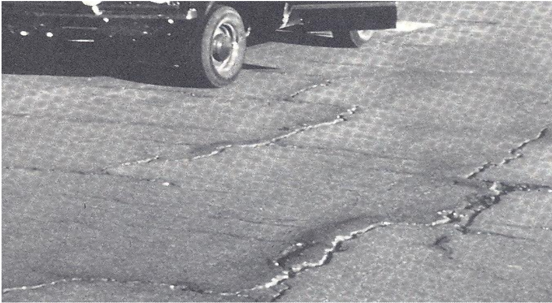
Figura 23. Agrietamiento en bloque con nivel de severidad alta (Fuente: Corros, Urbáez y Corredor (2009))
