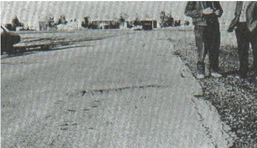
Figura 25. Abultamientos y hundimientos con nivel de severidad media (Fuente: Vásquez (2002))
