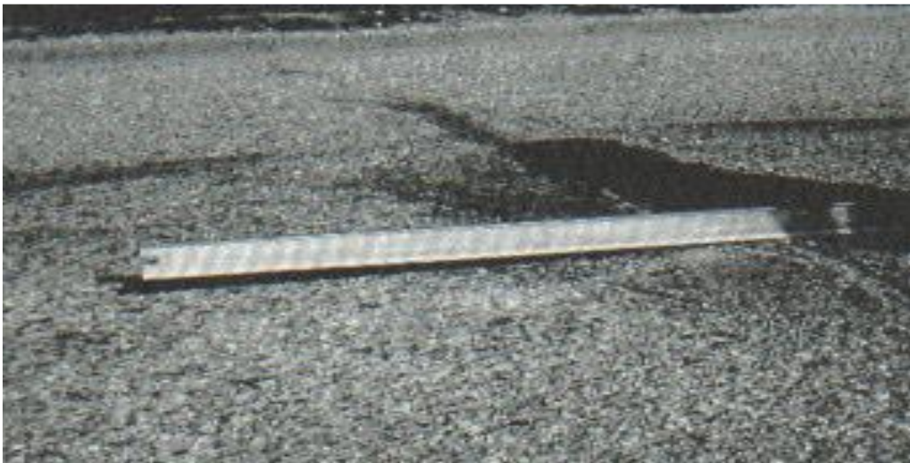
Figura 24. Abultamientos y hundimientos con nivel de severidad bajo o leve (Fuente: Vásquez (2002))
