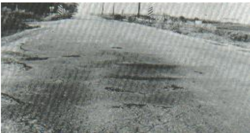
Figura 59. Desplazamiento con nivel de severidad media (Fuente: Vásquez (2002))
