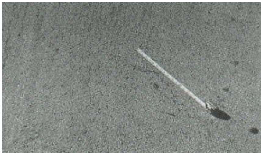
Figura 61. Grietas parabólicas con nivel de severidad bajo o leve (Fuente: Vásquez (2002))
