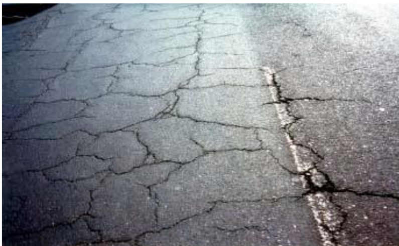
Figura 22. Agrietamiento en bloque con nivel de severidad media (Fuente: Corros, Urbáez y Corredor (2009))
