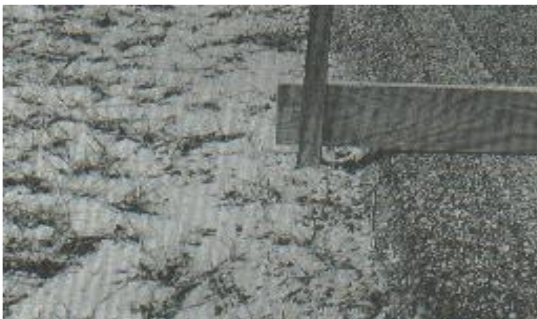
Figura 39. Desnivel carril/berma con nivel de severidad bajo o leve (Fuente: Vásquez (2002))
