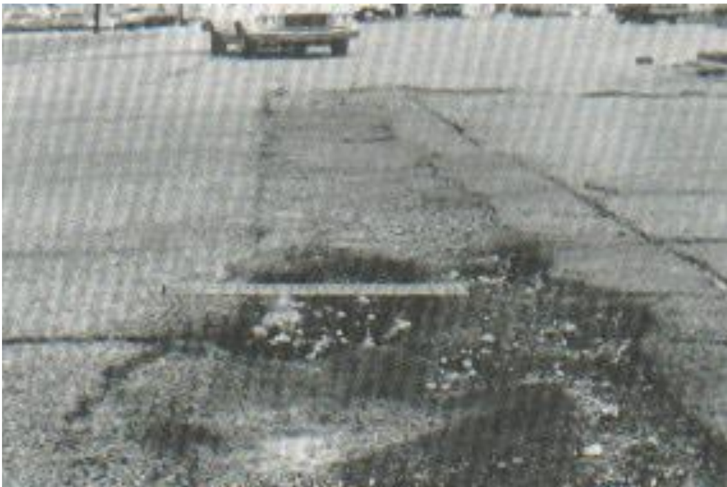
Figura 47. Parcheo y acometidas de servicio con nivel de severidad alta (Fuente: Vásquez (2002))
