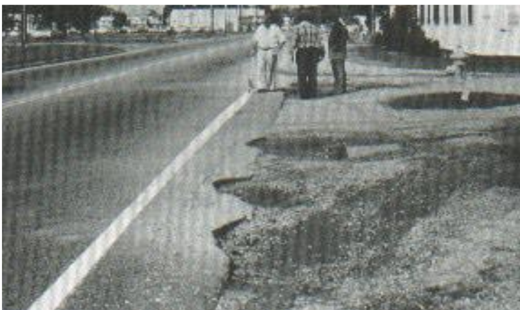
Figura 35. Grieta de borde con nivel de severidad alta (Fuente: Vásquez (2002))
