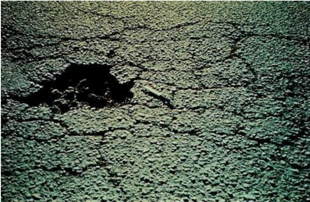
Figura 17. Piel de cocodrilo con nivel de severidad alto (Fuente: Corros, Urbáez y Corredor (2009))
