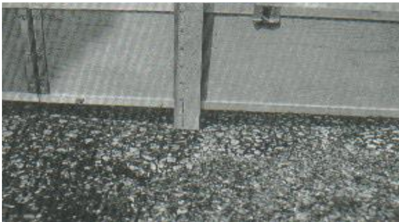
Figura 57. Ahuellamiento con nivel de severidad alta (Fuente: Vásquez (2002))
