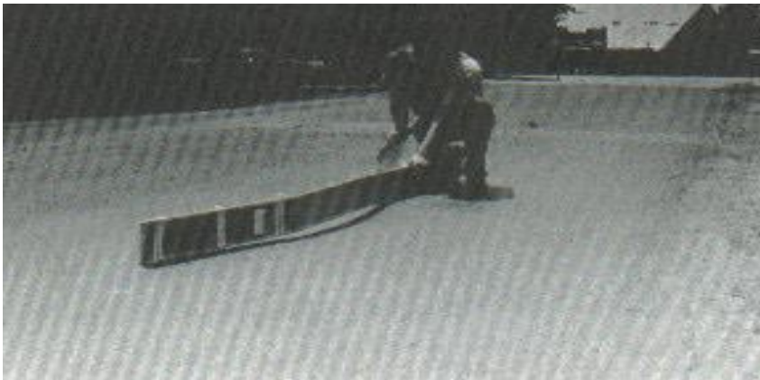
Figura 58. Desplazamiento con nivel de severidad leve (Fuente: Vásquez (2002))
