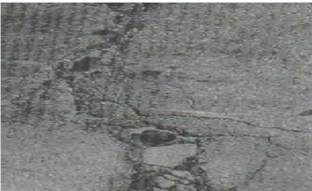
Figura 44. Grietas longitudinales y transversales con nivel de severidad alta (Fuente: Vásquez (2002))
