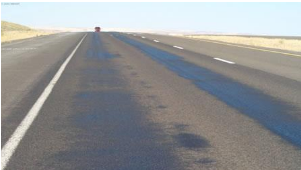
Figura 19. Exudación con nivel de severidad media (Fuente: Corros, Urbáez y Corredor (2009))
