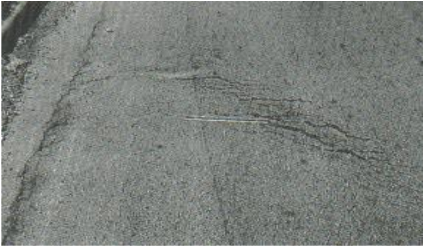
Figura 62. Grietas parabólicas con nivel de severidad media (Fuente: Vásquez (2002))
