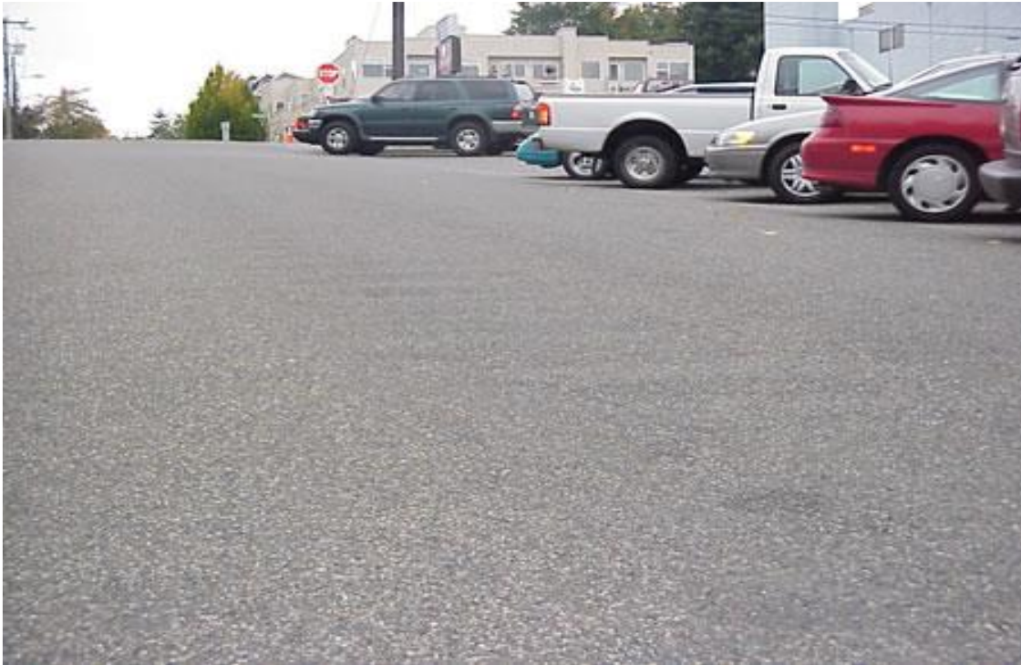
Figura 27. Corrugación con nivel de severidad bajo o leve (Fuente: Corros, Urbáez y Corredor (2009))
