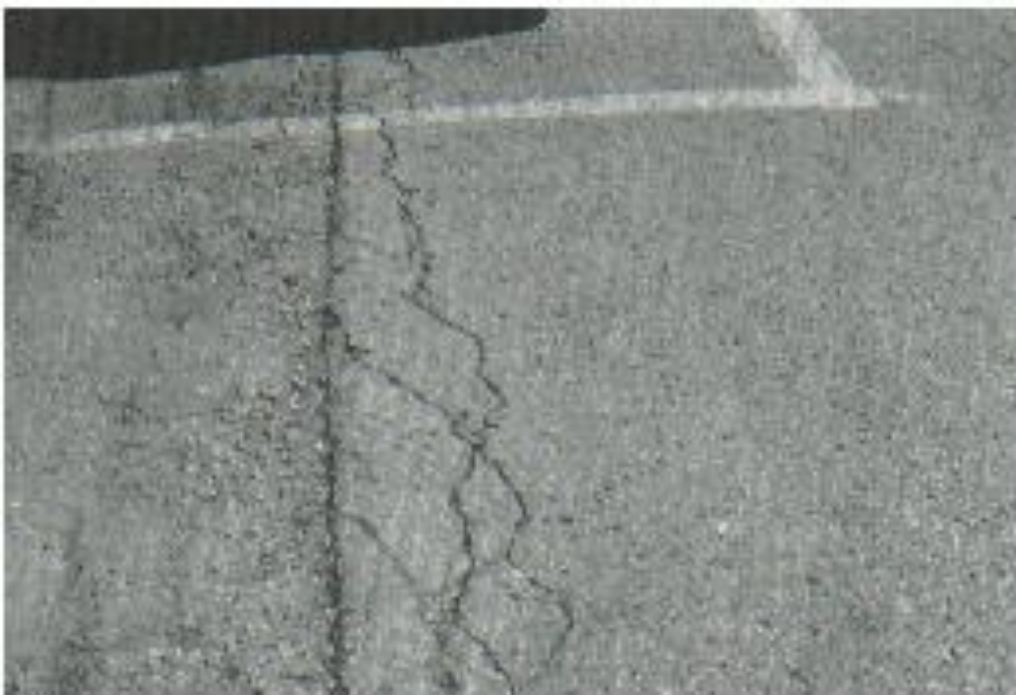
Figura 34. Grieta de borde con nivel de severidad media (Fuente: Vásquez (2002))
