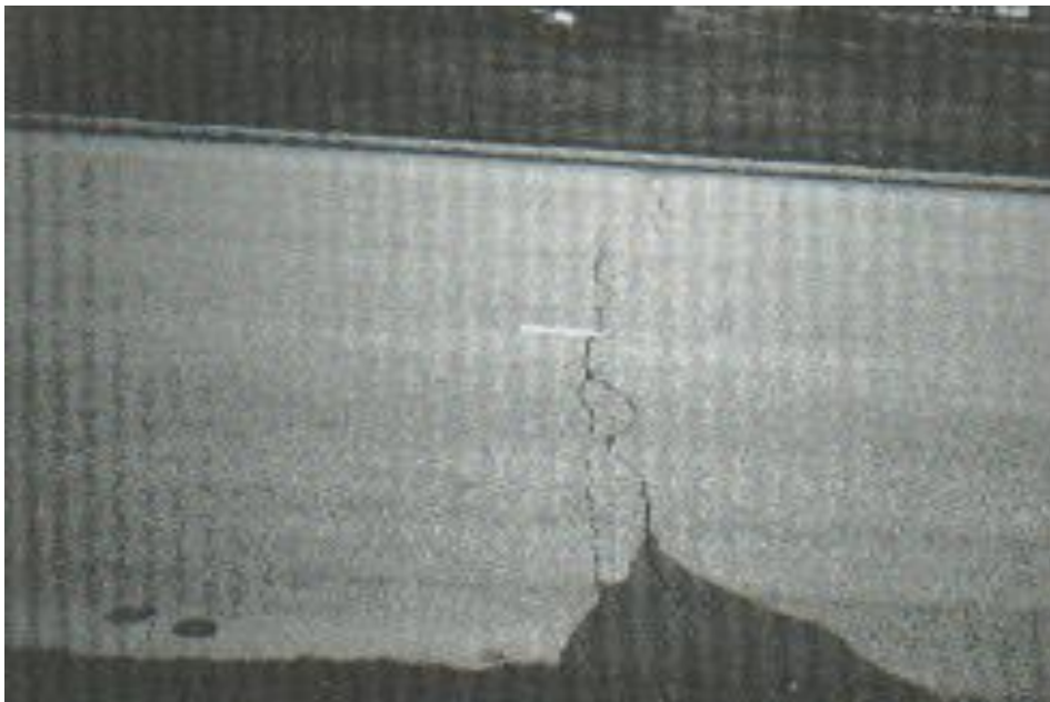
Figura 43. Grietas longitudinales y transversales con nivel de severidad media (Fuente: Vásquez (2002))
