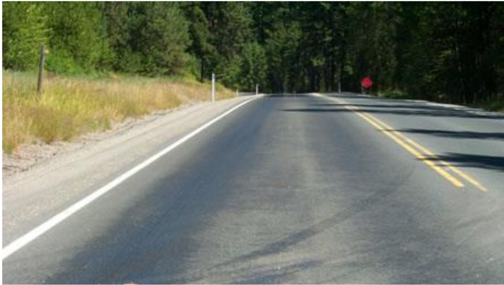
Figura 18. Exudación con nivel de severidad bajo o leve (Fuente: Corros, Urbáez y Corredor (2009))
