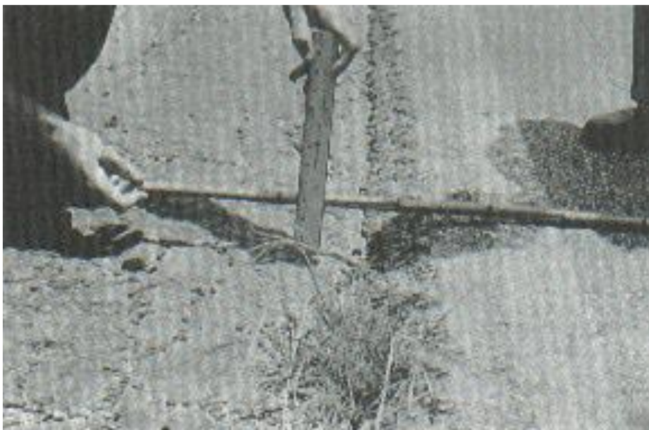
Figura 40. Desnivel carril/berma con nivel de severidad media (Fuente: Vásquez (2002))
