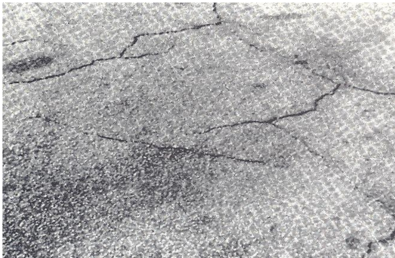
Figura 21. Agrietamiento en bloque con nivel de severidad leve o bajo (Fuente: Corros, Urbáez y Corredor (2009))
