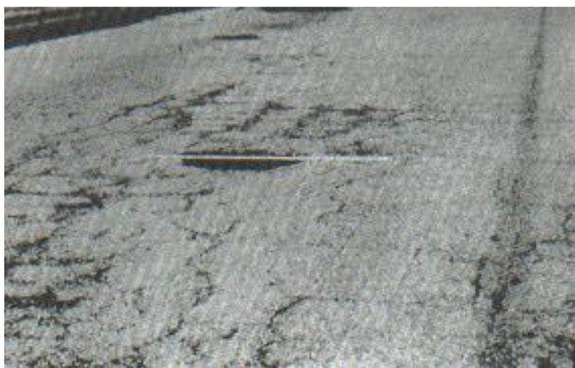
Figura 50. Huecos con nivel de severidad media (Fuente: Vásquez (2002))
