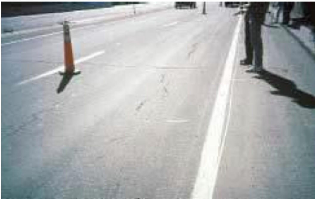
Figura 15. Piel de cocodrilo con nivel de severidad bajo o leve (Corros, Urbáez y Corredor (2009))
