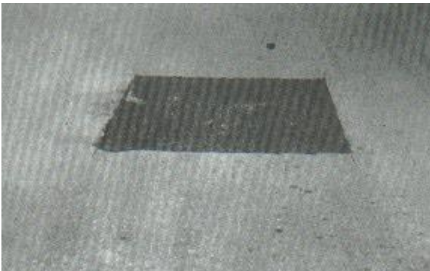
Figura 45. Parcheo y acometidas de servicio con nivel de severidad bajo o leve (Fuente: Vásquez (2002))
