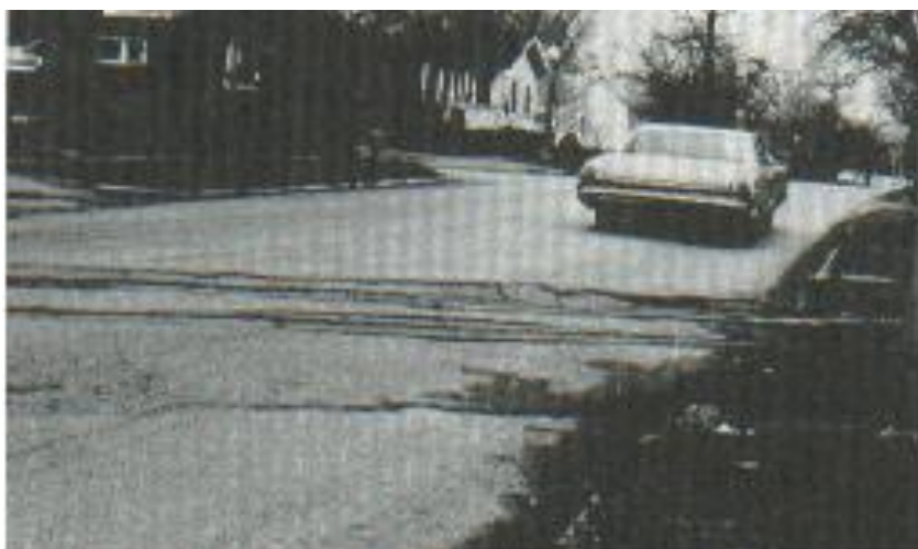
Figura 54. Cruce de vía férrea con nivel de severidad alta (Fuente: Vásquez (2002))
