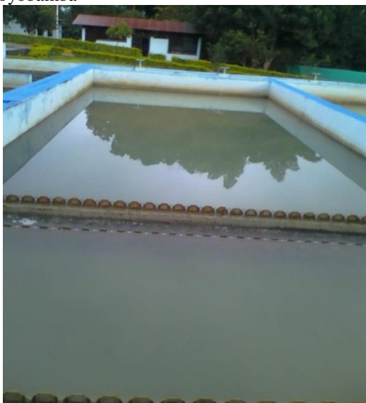
Fotografía 03. Decantadores de flujo horizontal
