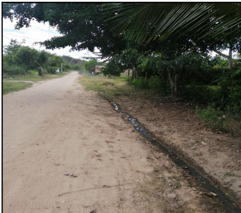
Ilustración 25: Se observa el escurrimiento de agua de lluvia por el Jr. Manuela Flores, generando focos de contaminación.
