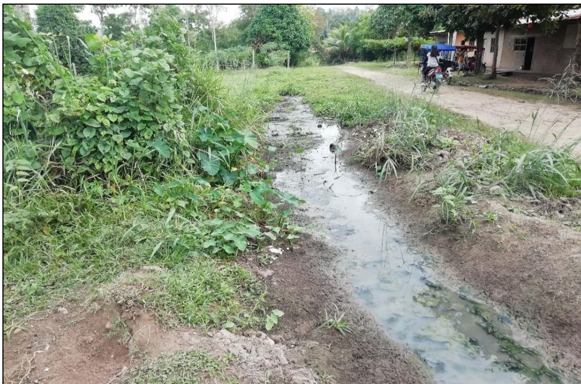
Ilustración 30: Se observa la acumulación de agua de lluvia, por la falta de estructuras de drenaje, causando focos de contaminación a la población.
