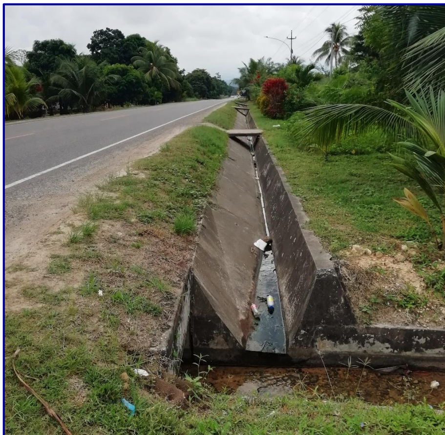
Ilustración 5: Sistema de drenaje existente, altura del km 6, de la carretera Marginal Sur.
