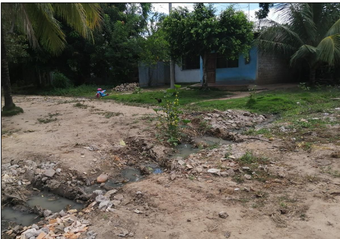
Ilustración 24: Se observa la acumulación de agua en las intercepciones de las calles, la cual genera un mal estado para el tránsito vehicular y peatonal.
