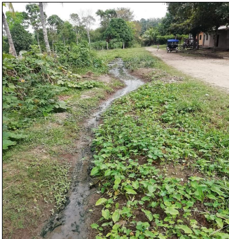
Ilustración 29: Se observa el escurrimiento de agua de lluvia por cunetas naturales, debido a la falta de estructuras de drenaje.
