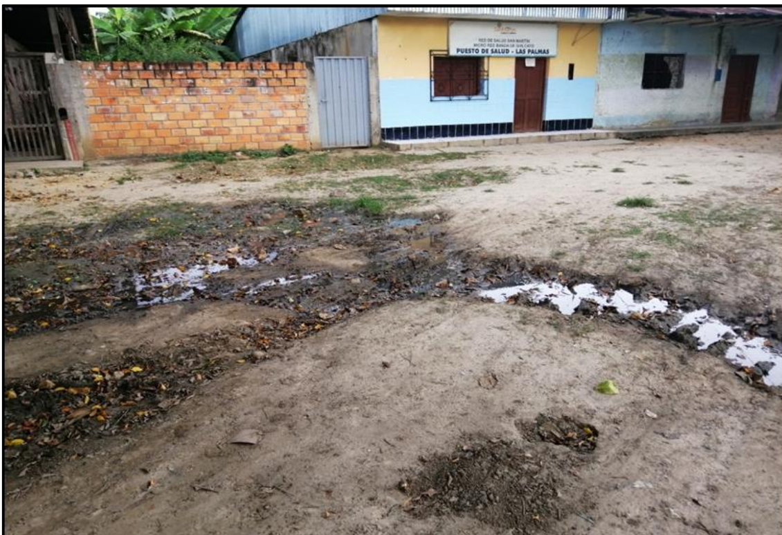
Ilustración 20: Se observa la acumulación de agua de lluvia por la falta de una estructura de drenaje generando fuente de contaminación y foco infeccioso.
