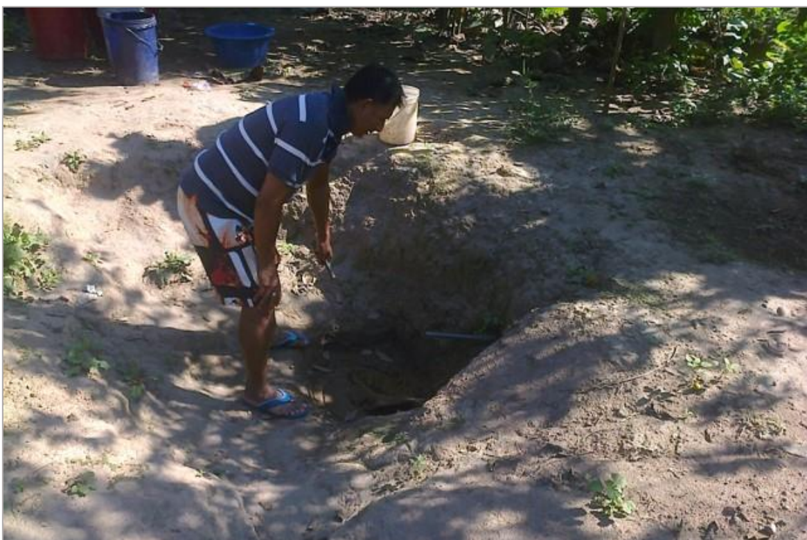
Fotografía 4: Conexión domiciliar existente y modificada para poder captar el agua potable.
