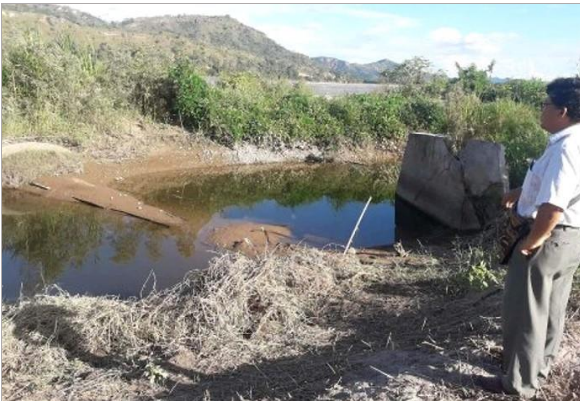
Fotografía 7: Verificación de tanque elevado colapsado.
