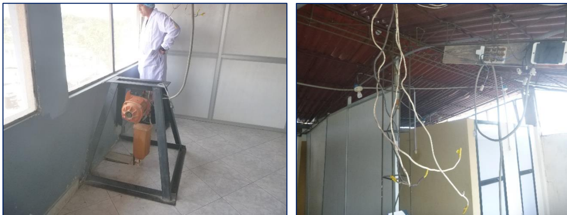
Figura 7. Tecele y sus instalaciones eléctricas
