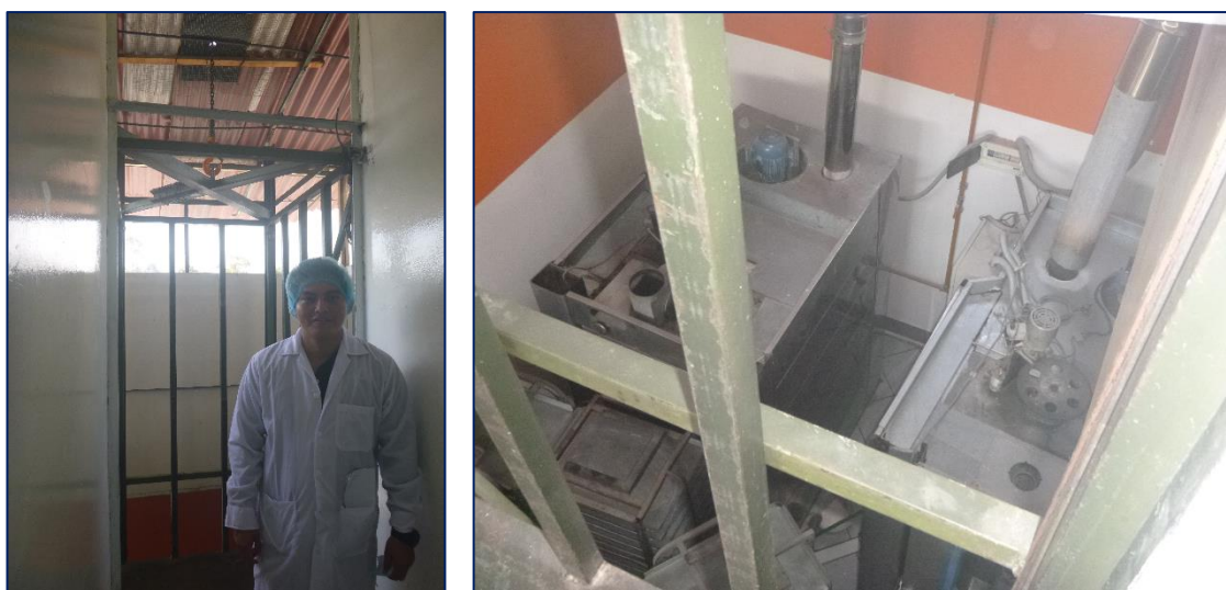
Figura 6. Elevador eléctrico para coches
