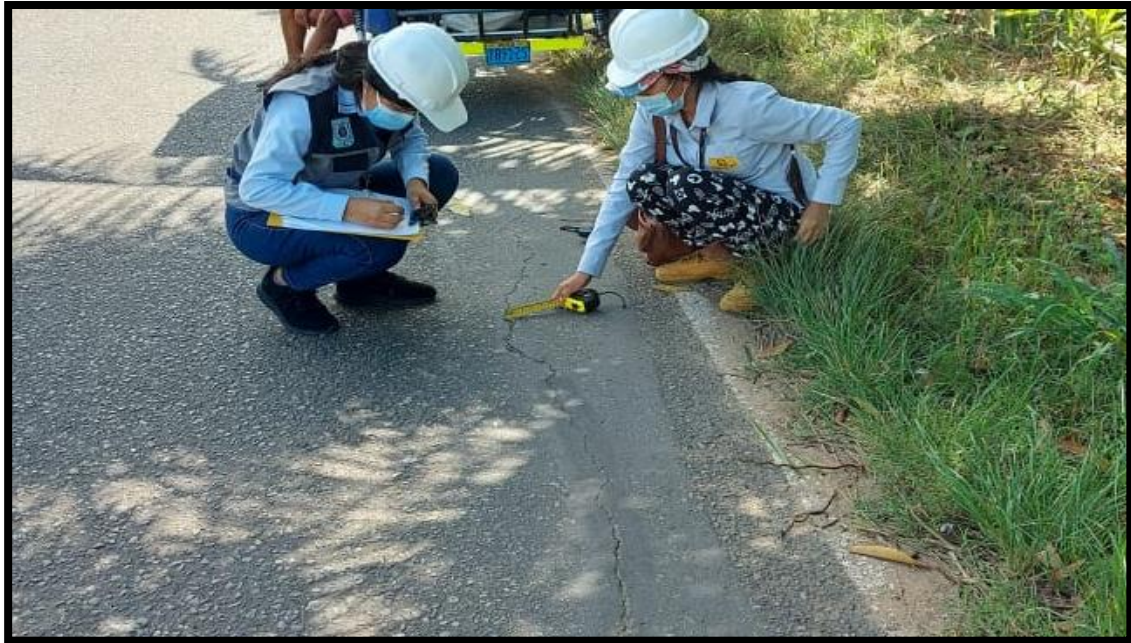
Figura 13: Identificación de Fallas, carril derecho Km 00+395. (Fuente Propia)
