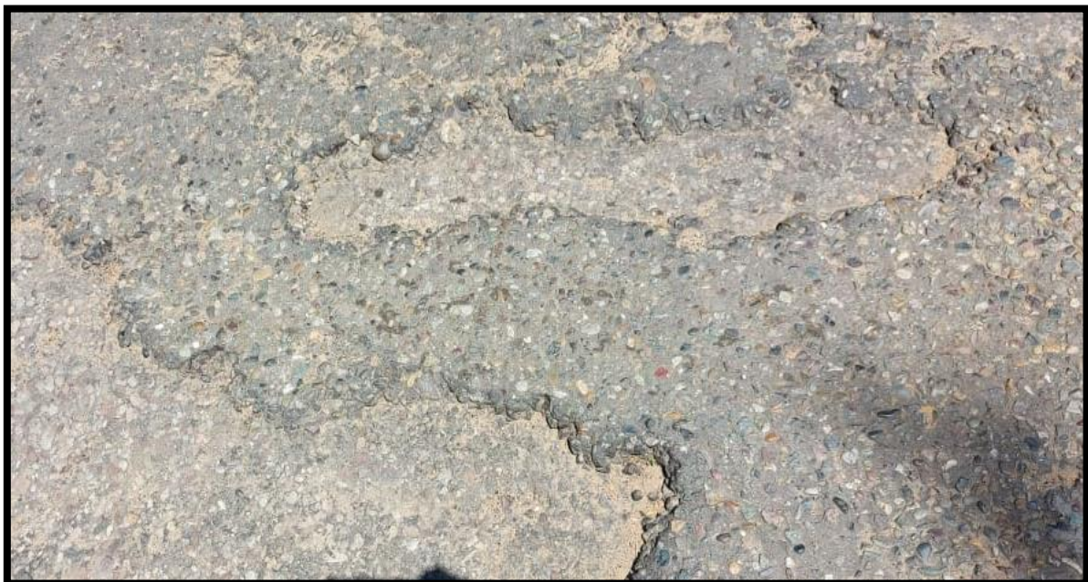
Figura 16: Desprendimiento de severidad alta en pavimento km 06+393. (Fuente Propia)
