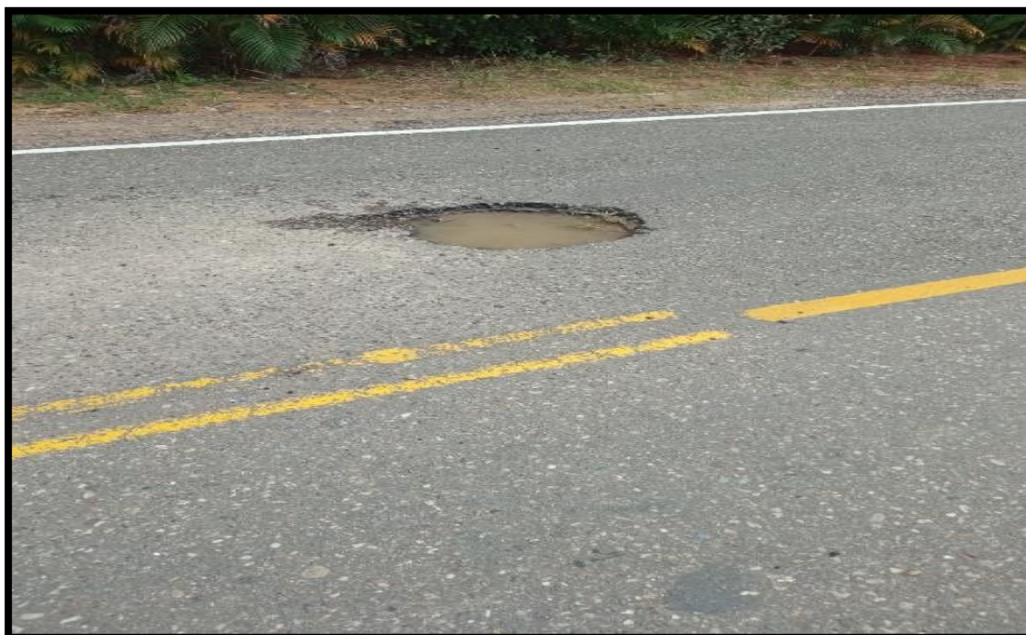
Figura 12: Se observa Desintegración por baches de severidad alta Km 08+196 . (Fuente Propia)
