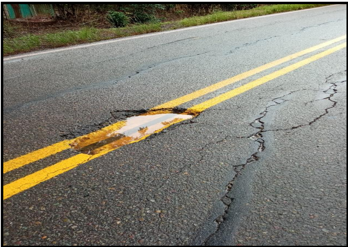
Figura 18. Fisuras de severidad alta km 01+086, se observa hundimiento de la carpeta asfáltica. (Fuente Propia)
