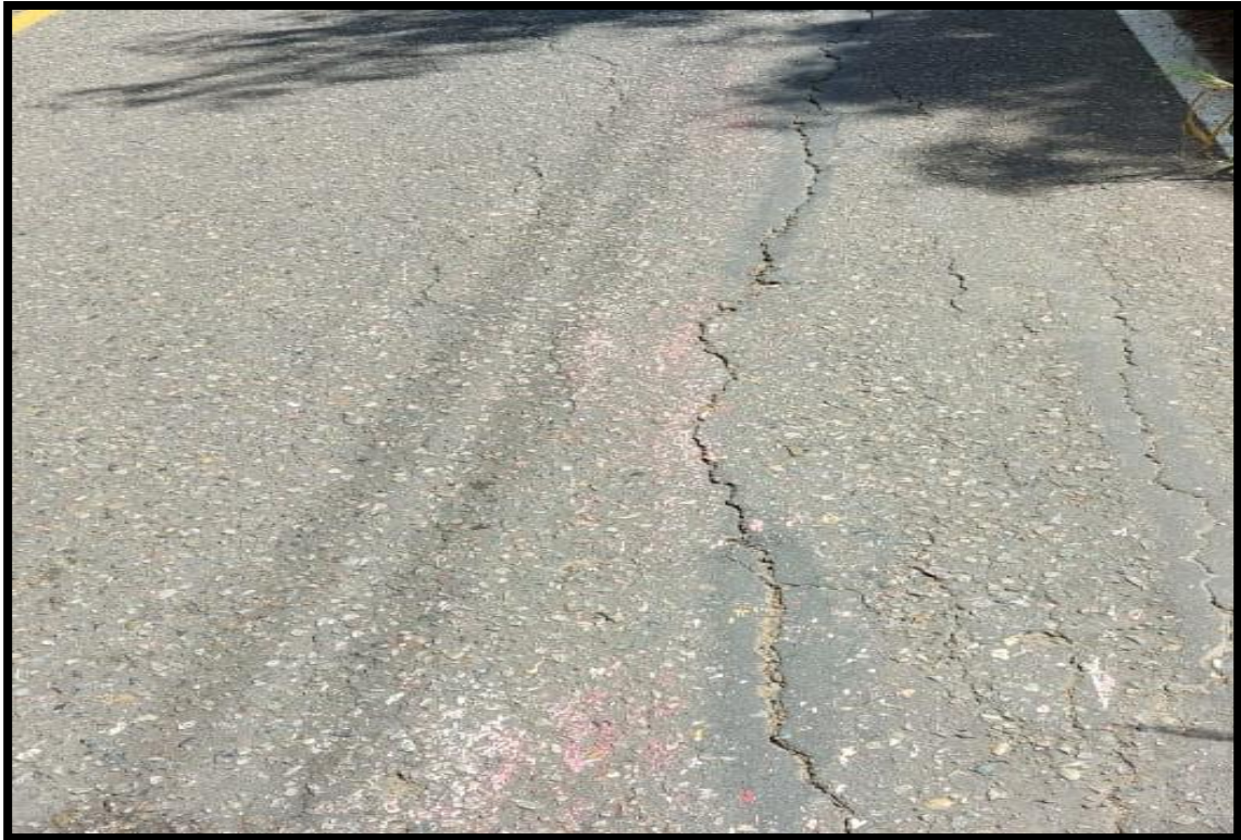
Figura 17. Fisuras en bloques km 00+115- severidad alta. (Fuente Propia)
