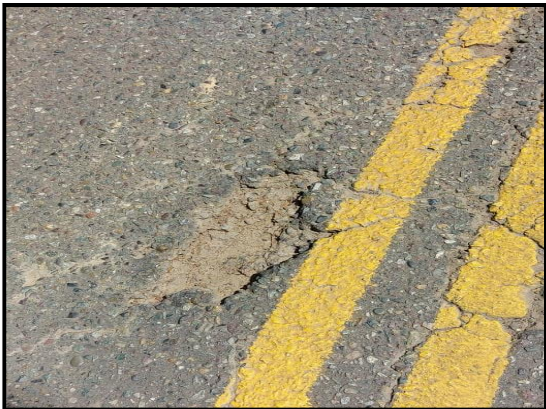
Figura 14. Desintegración de pavimento y fisuras km 02+044. (Fuente Propia)
