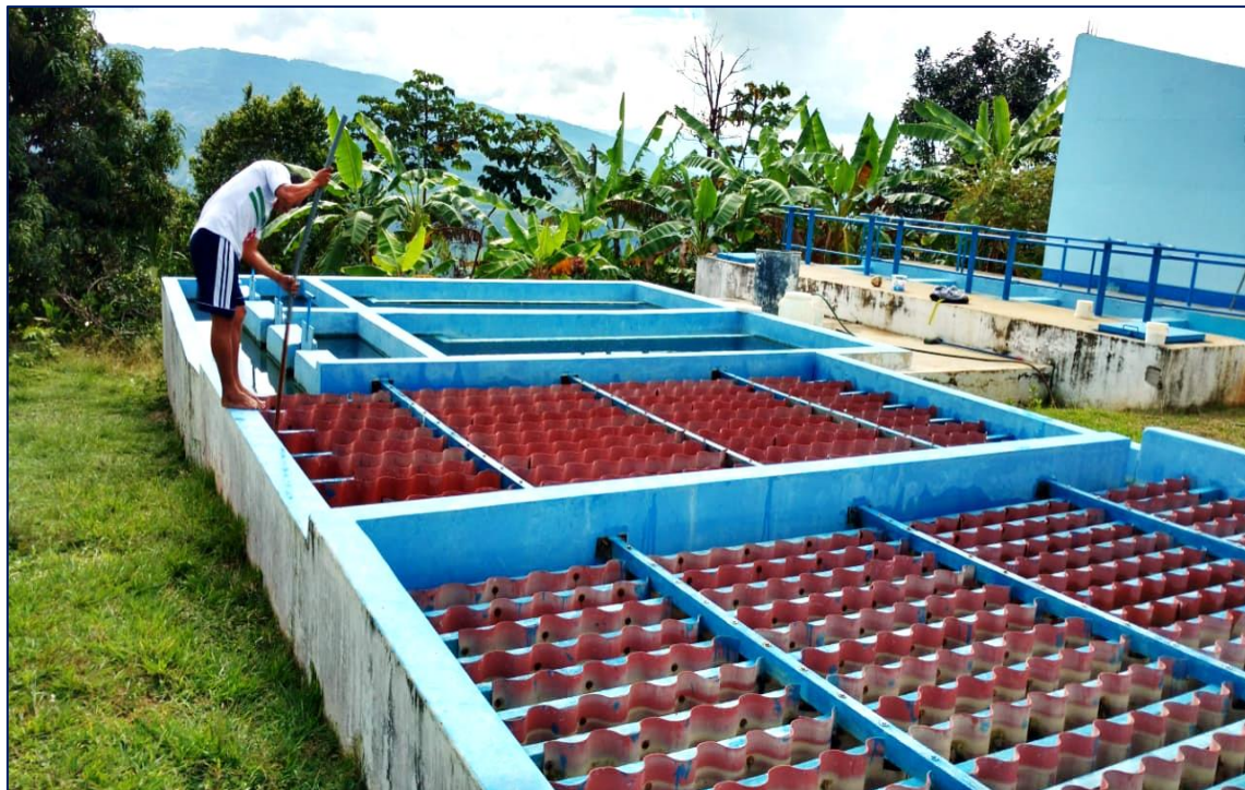
Fotografía 1. Vista de la planta de tratamiento
