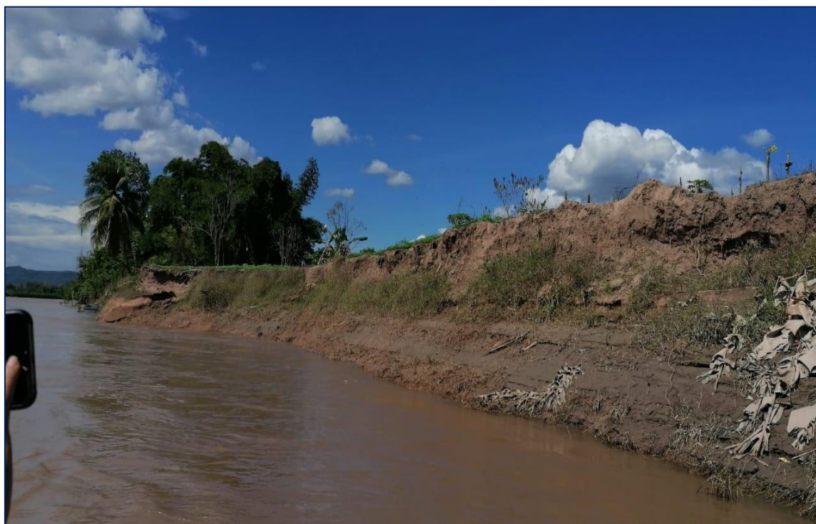
Figura 2. Verificación de la erosión de la margen derecha. Autor: Diana Arell Abanto Díaz
