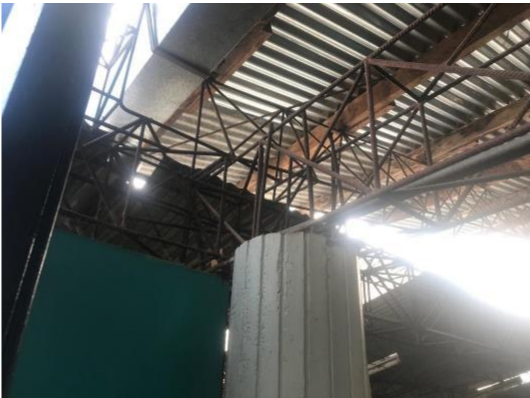
Foto 6: Detalle de la unión entre las columnas de Concreto armado y los tijerales longitudinales de acero estructural f_y = 4200 \text{ kg/cm}^2
