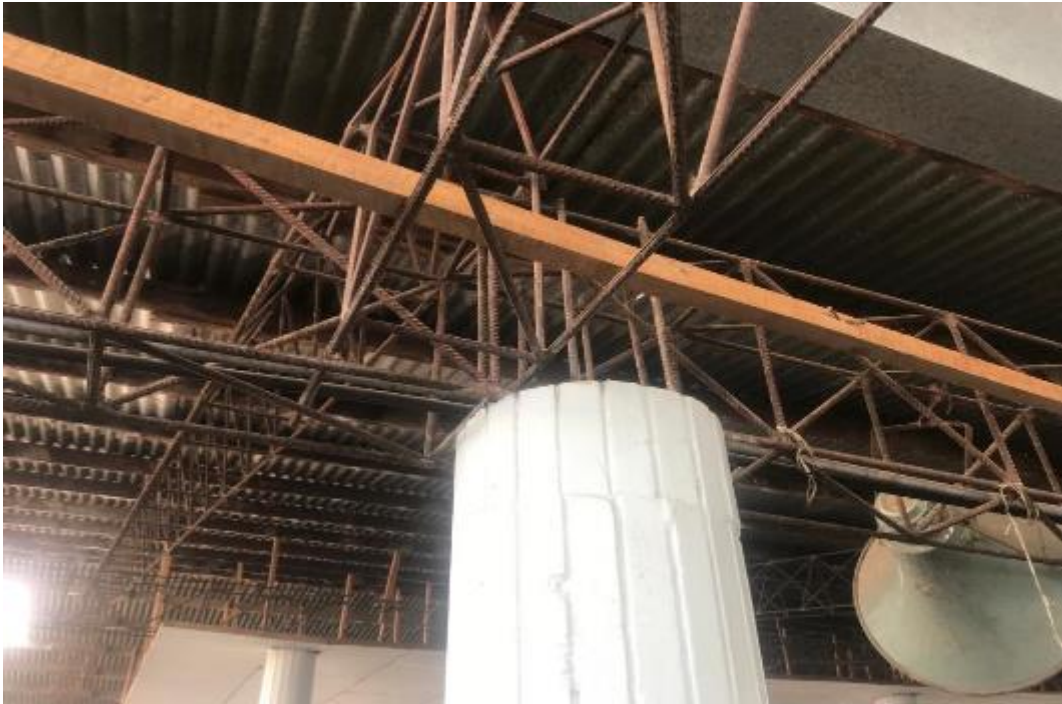
Foto 5: Detalle de la unión entre las columnas de Concreto armado y los tijerales estructurales transversales de acero estructural f_y = 4200 \text{ kg/cm}^2 .
