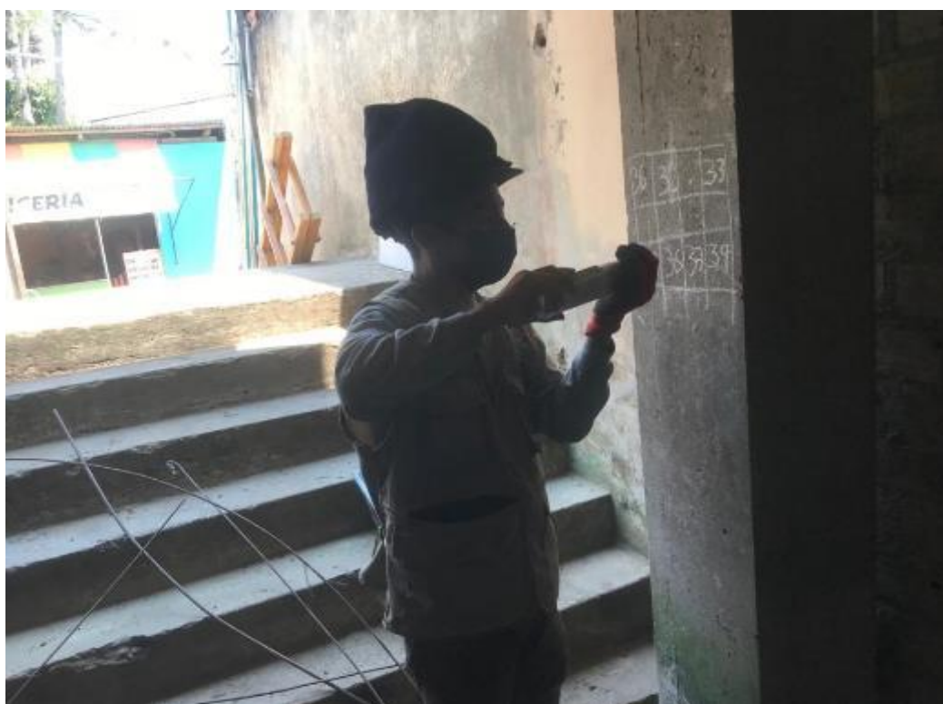
Foto 2: Punto N° 01 Uso del esclerómetro en las columnas del tanque de agua del Mercado Modelo Soritor.
