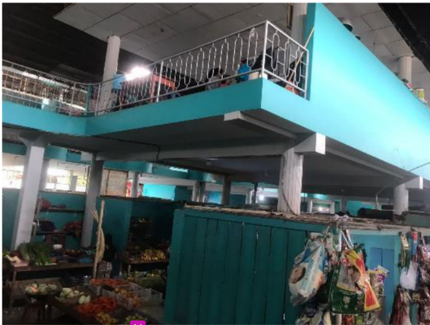
Foto 8: Vista completa de 14 la situación estructural actual de la estructura.
