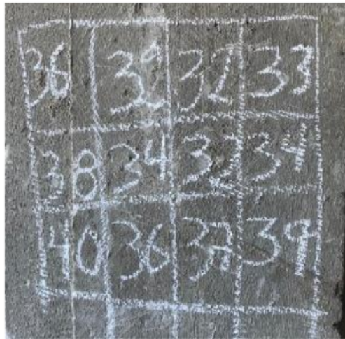
Foto 4: Punto N° 02 resultado de los golpes en la viga del tanque de agua del Mercado Modelo Soritor.
