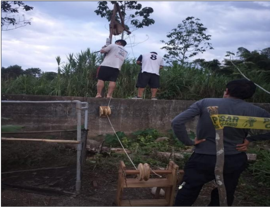
Fotografía 5: Instalación de un sistema de poleas para levantar la caja receptora de residuos.
