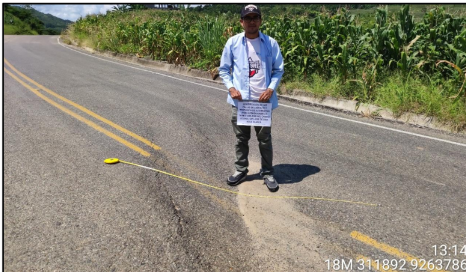
Figura 17. Deformaciones por Deficiencia Estructural (Hundimiento) – km 6+520
