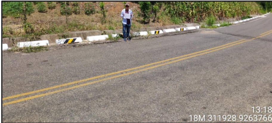
Figura 18. Deformaciones por Deficiencia Estructural (Hundimiento) – km 6+520
