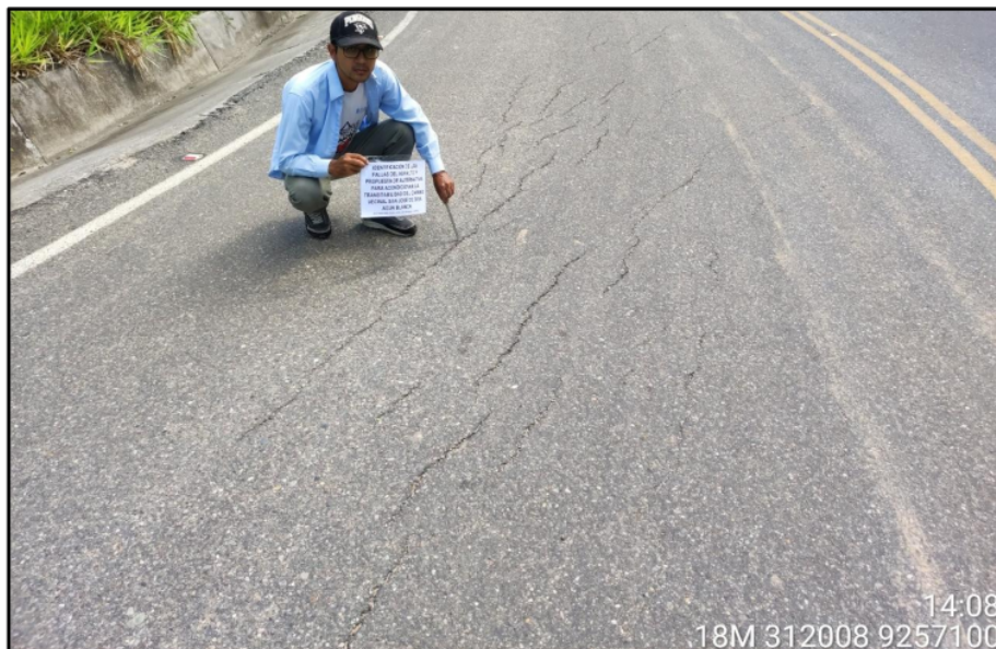
Figura 28. Fisuras Longitudinales – km 15+510
