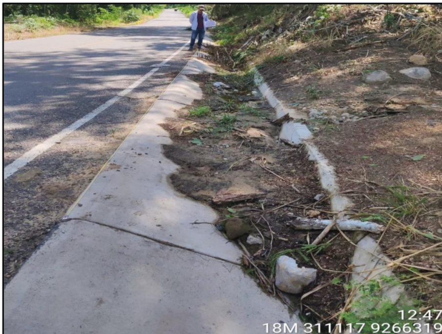
Figura 10. Peladura y Desprendimiento – km 3+040
