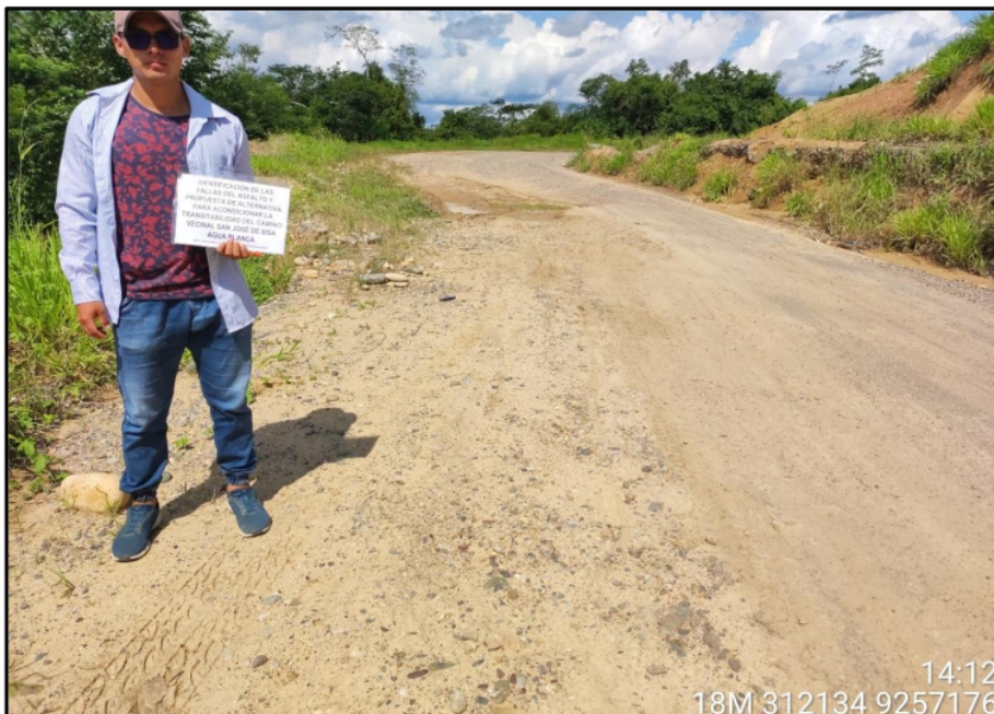
Figura 29. Peladura y Desprendimiento de Agregados – km 15+720
