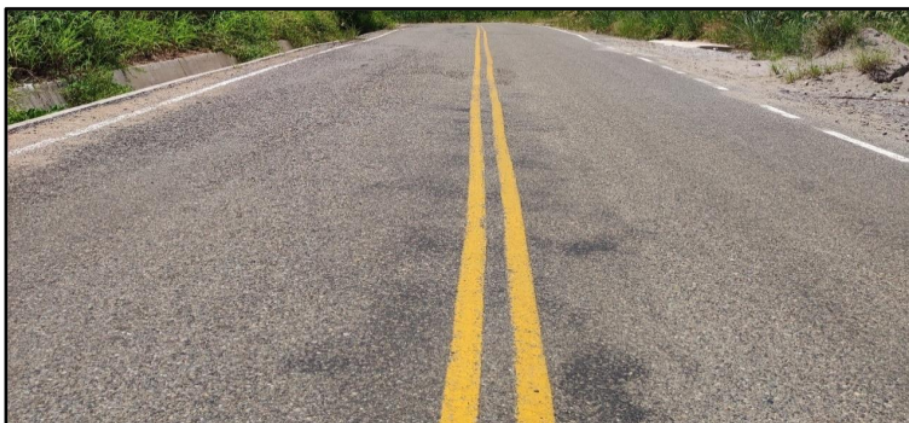
Figura 16. Peladura y Desprendimiento de Agregados – km 5+805
