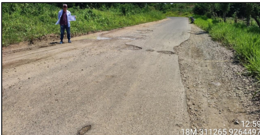
Figura 13. Peladura y Desprendimiento de Agregados – km 5+510
