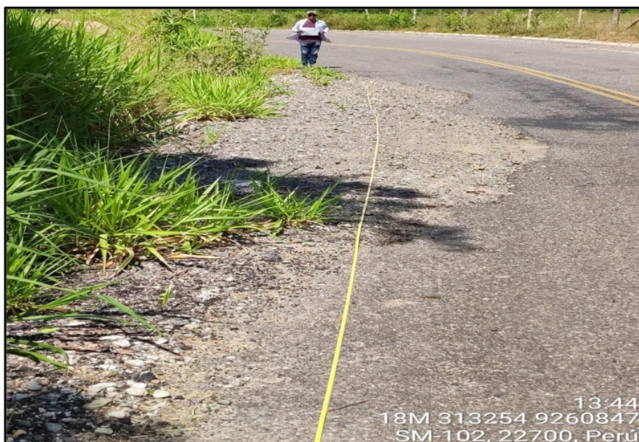
Figura 24. Peladura y Desprendimiento de Agregados – km 10+530
