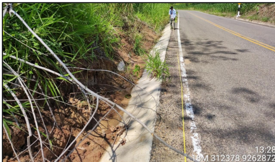
Figura 20. Peladura y Desprendimiento de Agregados – km 7+810
