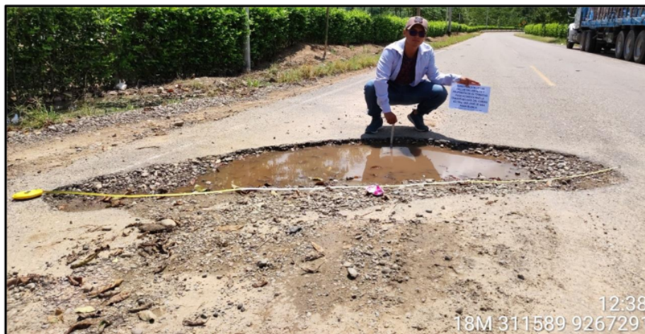
Figura 8. Peladura y Desprendimiento – km 1+400
