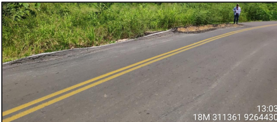
Figura 14. Deformaciones por Deficiencia Estructural (Hundimiento) – km 5+730
