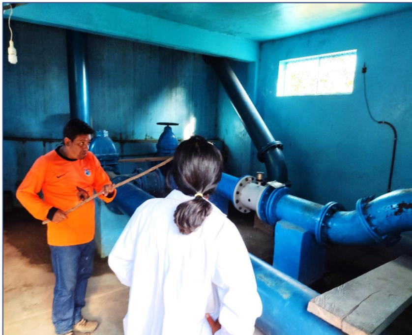
Fotografía 6. Con personal que labora en el cuidado de dicho sistema de abastecimiento
