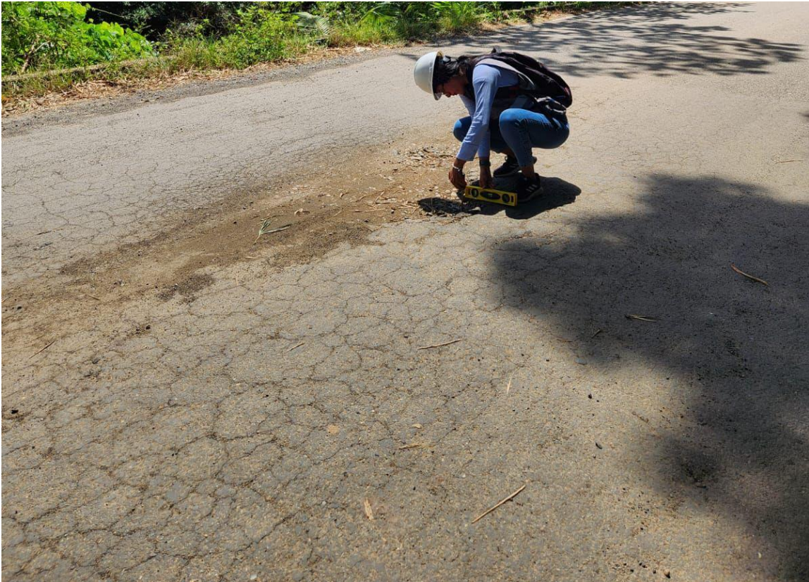
Figura 11. Progresiva: Km 0+560: Evaluación de piel de cocodrilo
