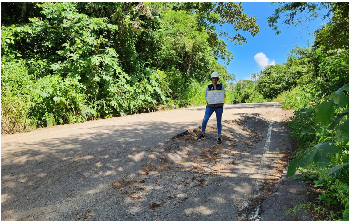
Figura 16. Progresiva: 5+180: Deformación por deficiencia estructural
