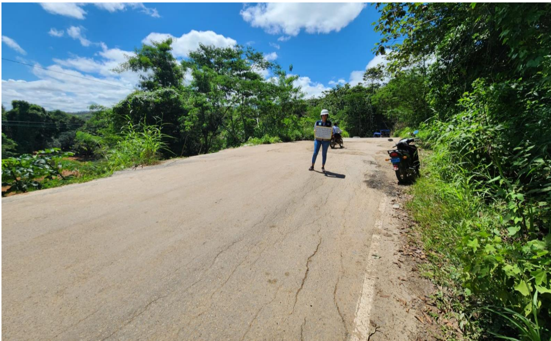
Figura 12. Progresiva: Km 0+800: Deformación por deficiencia y fisuras longitudinales
