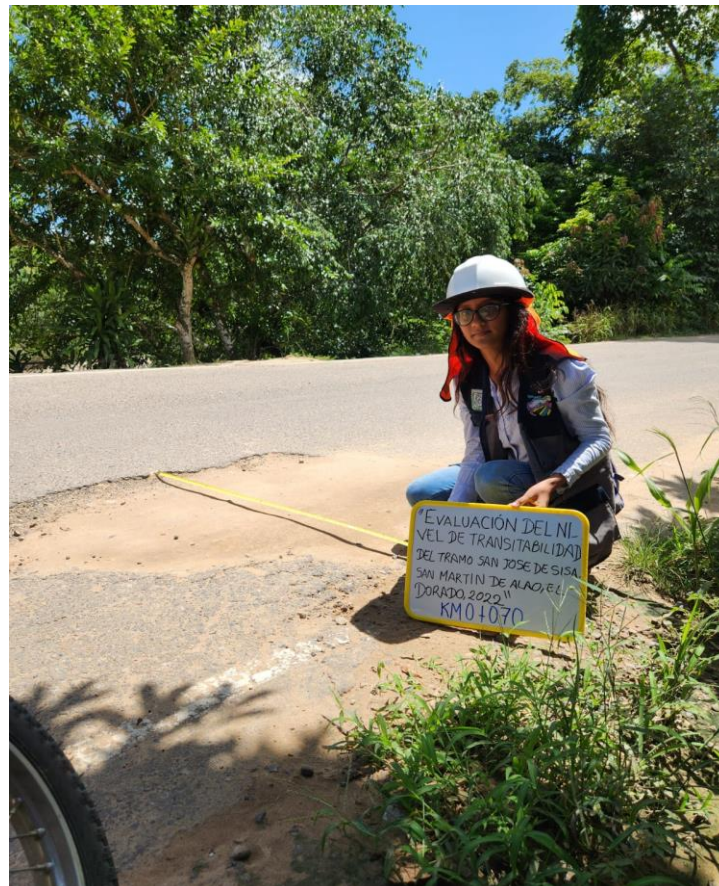
Figura 10. Progresiva: Km 0+ 070: Evaluación de bache
