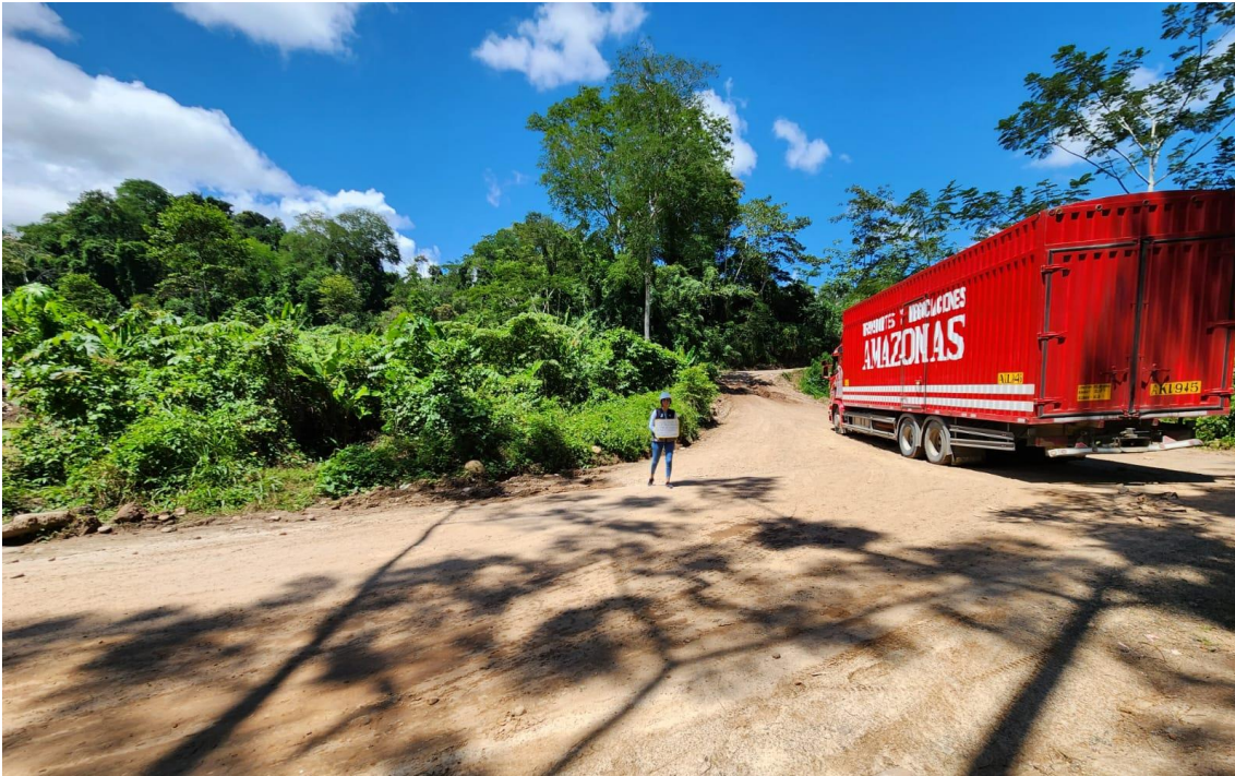
Figura 17. Progresiva: 5+600: Desprendimiento de carpeta asfáltica
