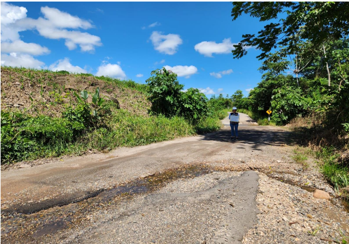
Figura 18. Progresiva: Km 8+500 Desprendimiento de carpeta asfáltica
