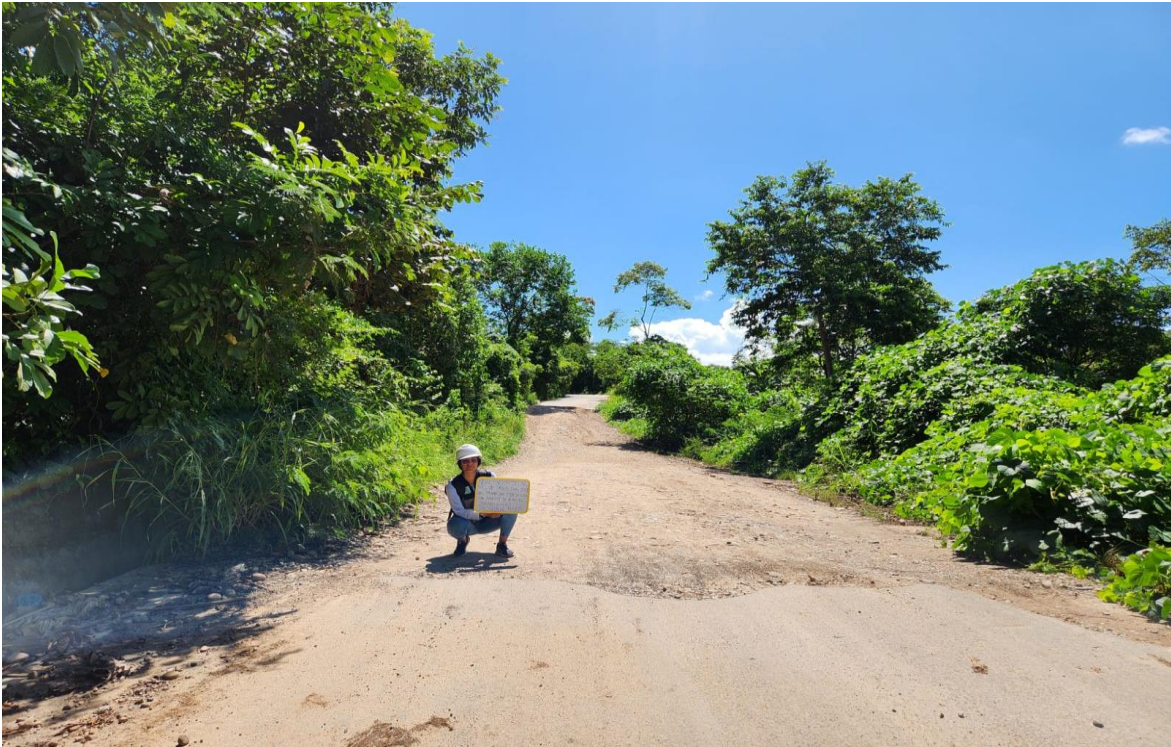
Figura 19. Progresiva: Km 13+300 Evaluación de sección crítica con desprendimiento de vía nivel de carpeta asfáltica.
