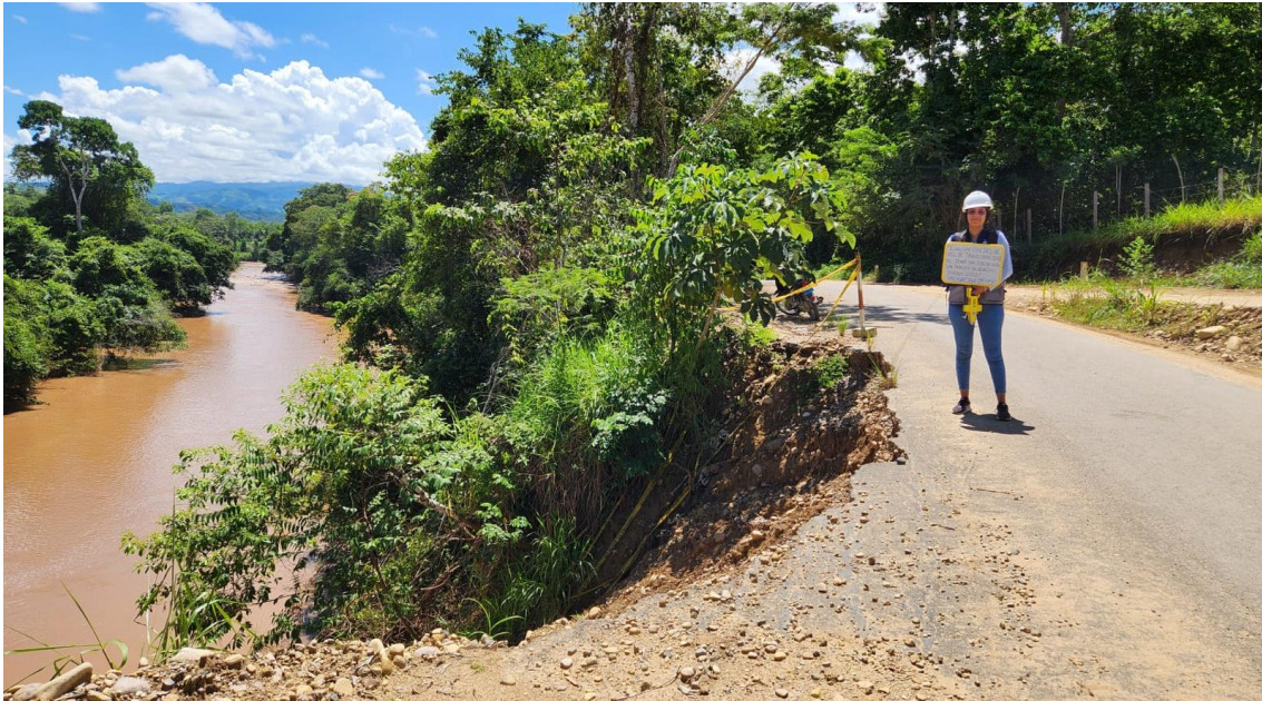
Figura 15. Progresiva: 4+200: Evaluación de la sección izquierda de la vía en estado crítico por erosión
