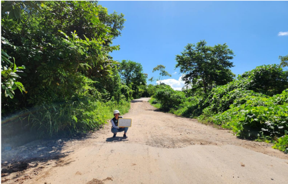
Figura 19. Progresiva: Km 13+300 Evaluación de sección crítica con desprendimiento de vía nivel de carpeta asfáltica.
