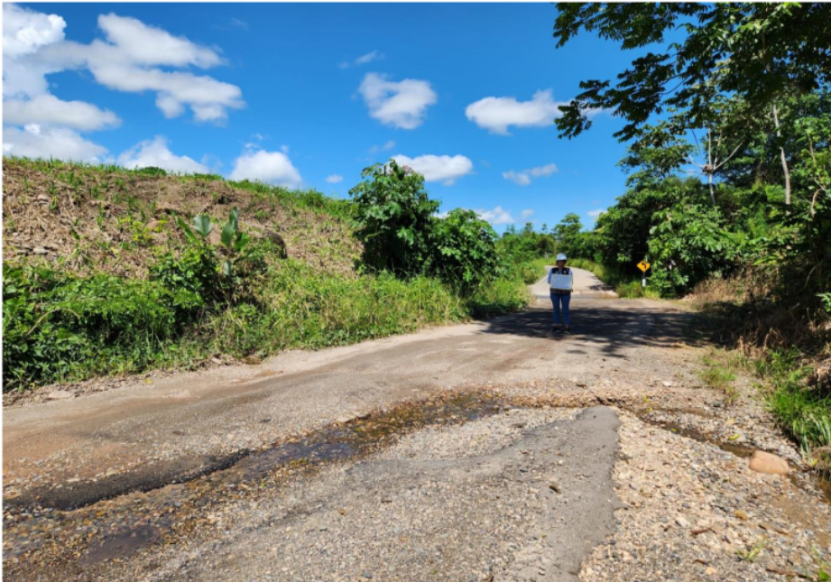
Figura 18. Progresiva: Km 8+500 Desprendimiento de carpeta asfáltica
