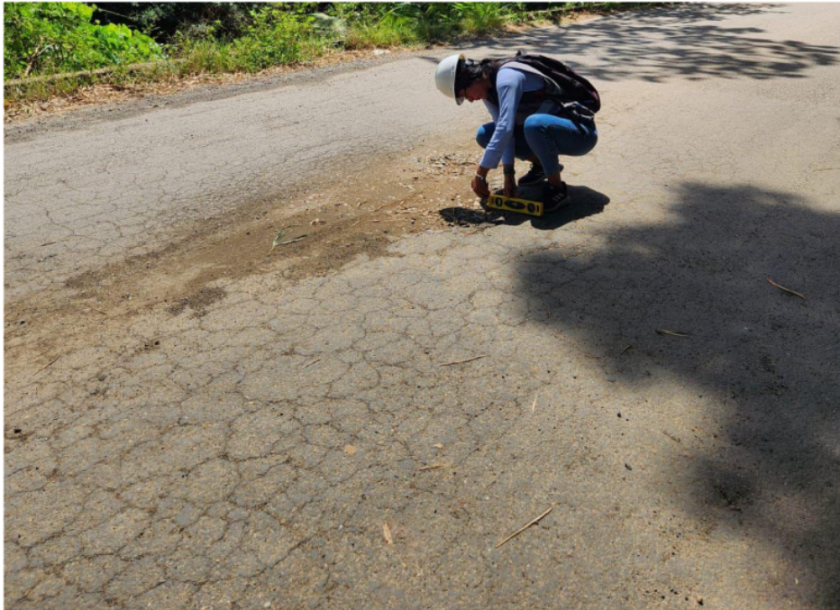
Figura 11. Progresiva: Km 0+560: Evaluación de piel de cocodrilo
