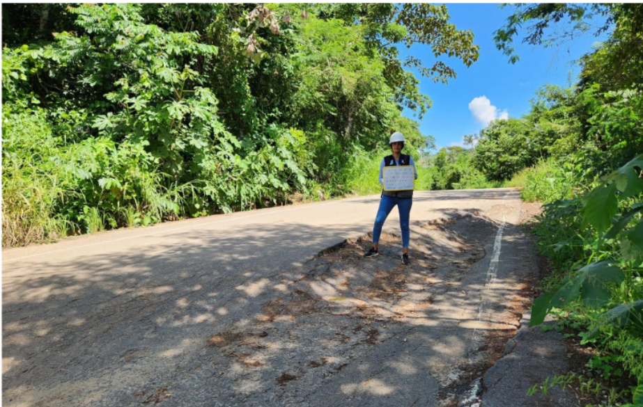
Figura 16. Progresiva: 5+180: Deformación por deficiencia estructural
