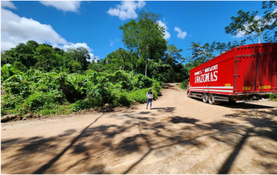
Figura 17. Progresiva: 5+600: Desprendimiento de carpeta asfáltica
