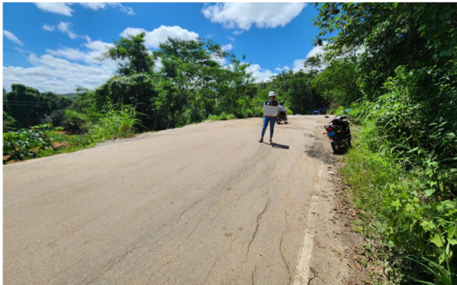
Figura 12. Progresiva: Km 0+800: Deformación por deficiencia y fisuras longitudinales
