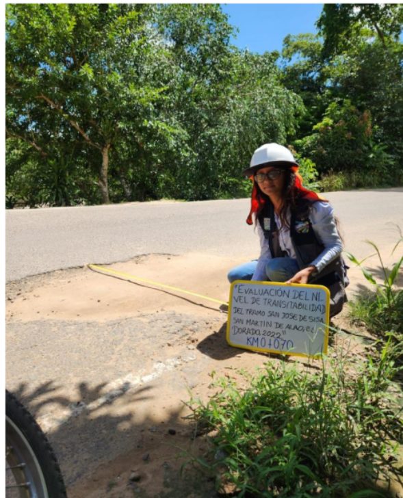
Figura 10. Progresiva: Km 0+ 070: Evaluación de bache
