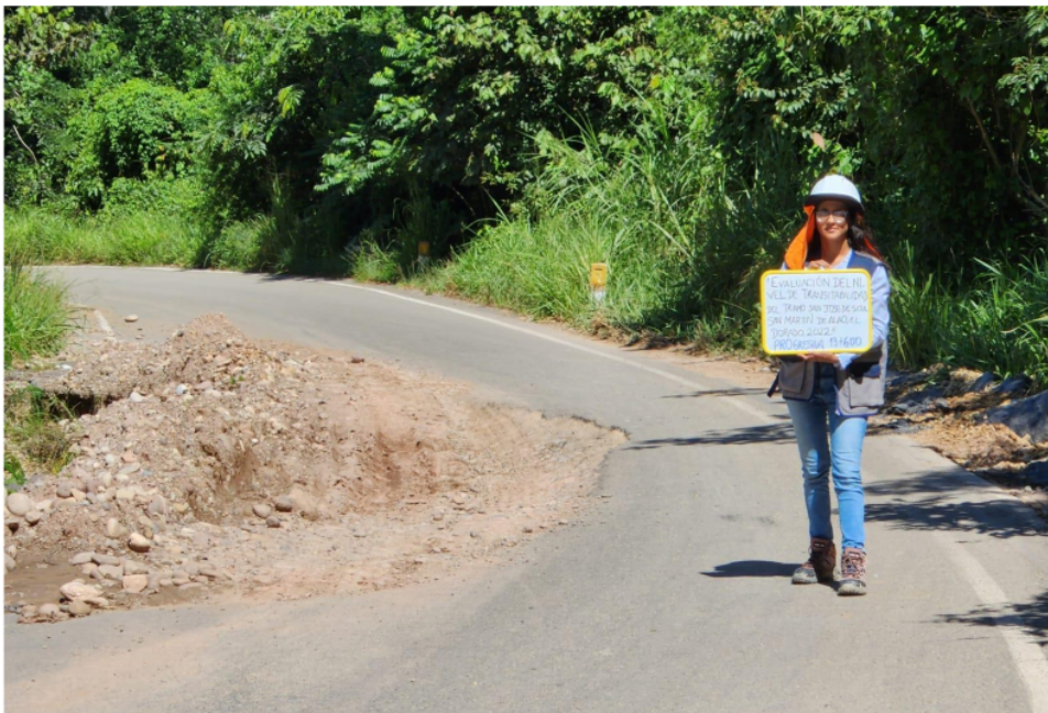
Figura 20. Progresiva: Km 13+600 Erosión lado izquierdo de la vía
