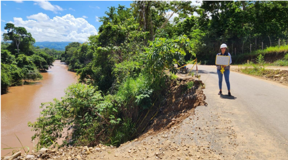
Figura 15. Progresiva: 4+200: Evaluación de la sección izquierda de la vía en estado crítico por erosión
