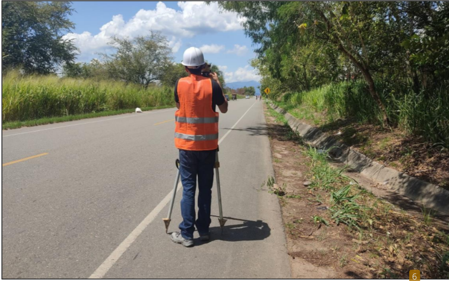
Figura 31. Recolección de datos con mira y nivel Tramo 2 (5+500 KM - 5+820 KM). Fuente: Elaboración propia.
