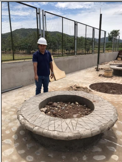
Fotografía N° 03: Desarrollo de las actividades de desencofrado de las bancas circulares de concreto.
