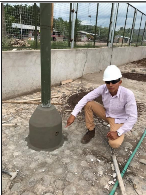
Fotografía N° 15: Vista del tarrajeo de muros C:A 1:5 E=1.5 cm en la base de las farolas ornamentales.
