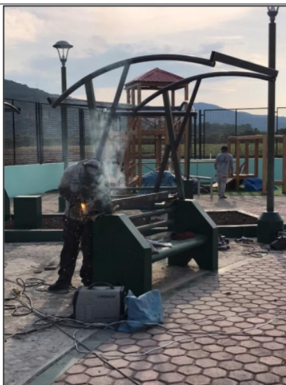
Fotografía N° 11: Desarrollo de las actividades de instalación de los tijerales metálicos de las bancas con techo.
