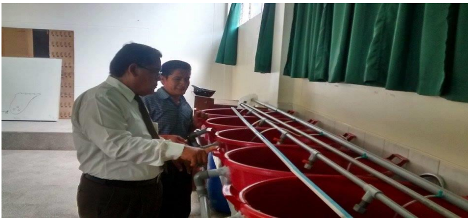
Figura 2. Instalación del sistema de recirculación cerrada
