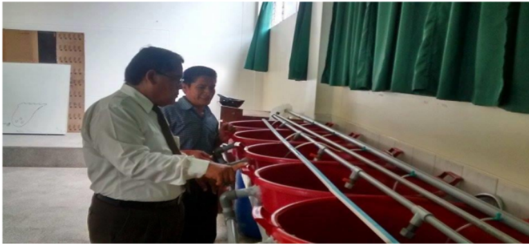
Figura 2. Instalación del sistema de recirculación cerrada
