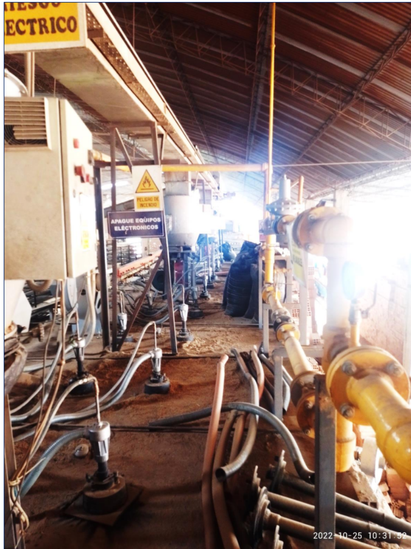
Foto 4: Inyectores de GNL al horno túnel para la cocción de ladrillos
