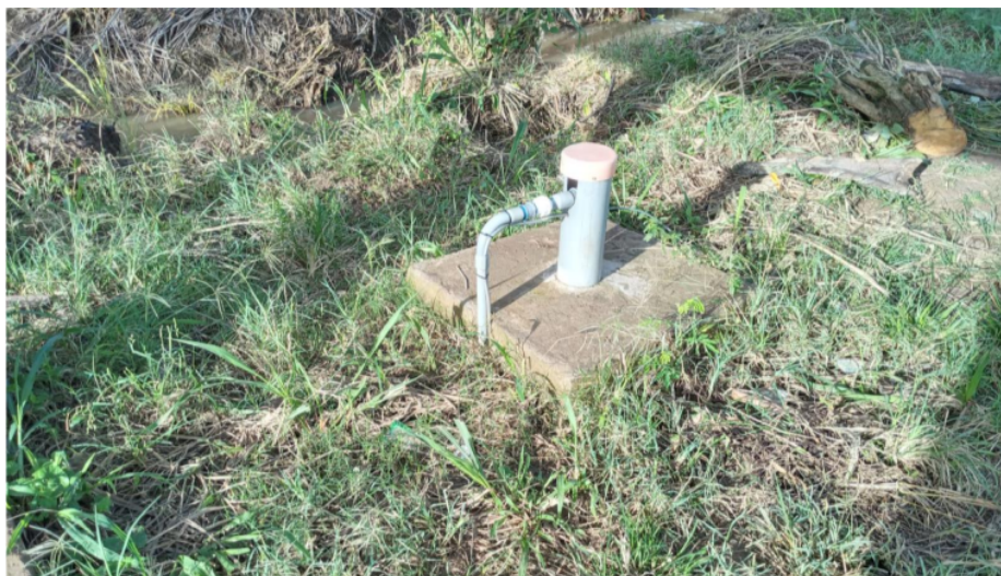
Figura 25 Ubicación de pozo tubular para bombeo de agua subterránea
