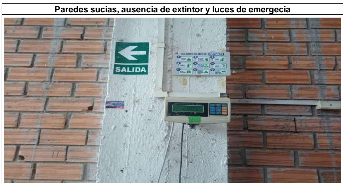
Figura 19 Paredes sucias, extintores y luces de emergencia en área de pesado.
