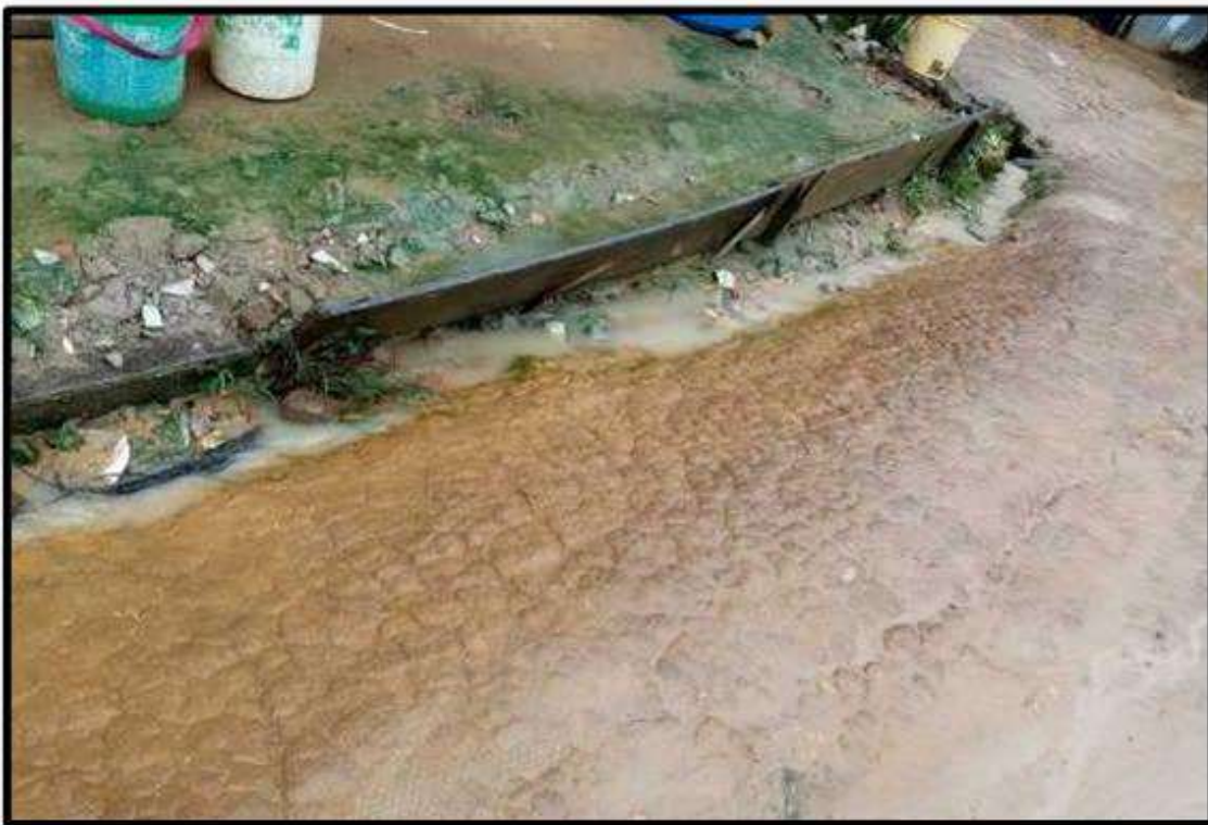
Foto 3: Un Mal sistema de drenaje pluvial es una fuente de contaminación y foco infeccioso.
