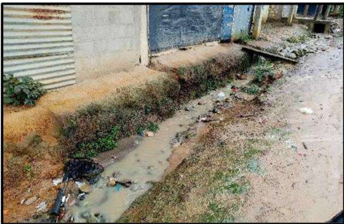
Foto 1: Se aprecia un ineficiente sistema de drenaje el cual afecta en la erosión de los terrenos y/o viviendas del caserío de aocaloma.
