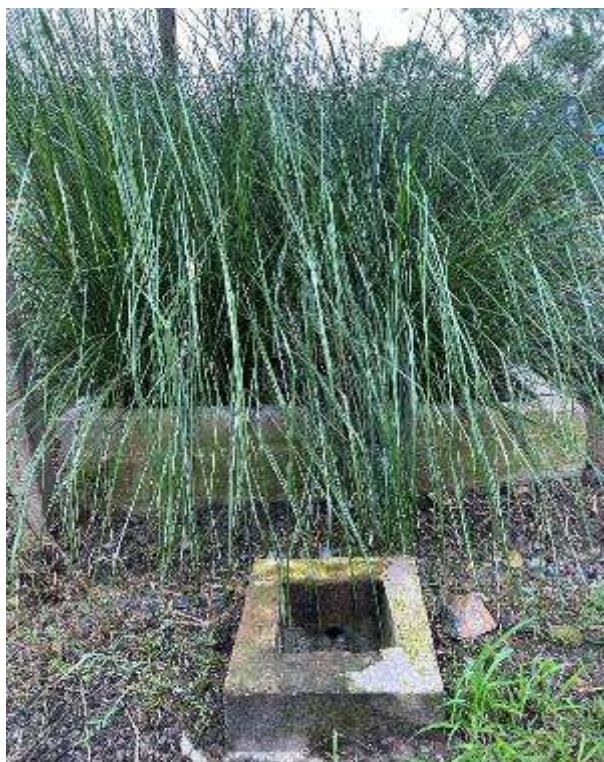
Fotografía 6. Humedal artificial en funcionamiento.
