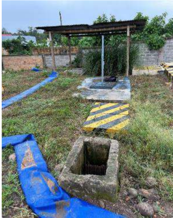
Fotografía 3. Vista general del tratamiento preliminar: Cámara de rejas (1), trampa de grasas (2) y tanque séptico (3). Ubicados en ese orden sucesivamente.
