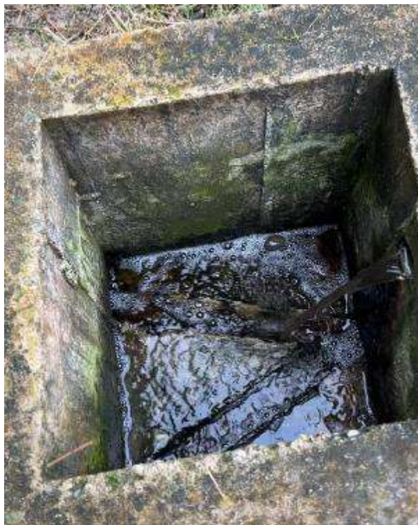
Fotografía 4. Llegada de aguas residuales a la cámara distribuidora de caudal.
