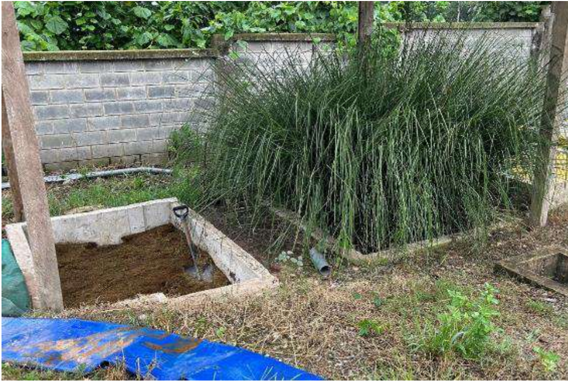
Fotografía 7. Lombrifiltro y humedal artificial en funcionamiento.
