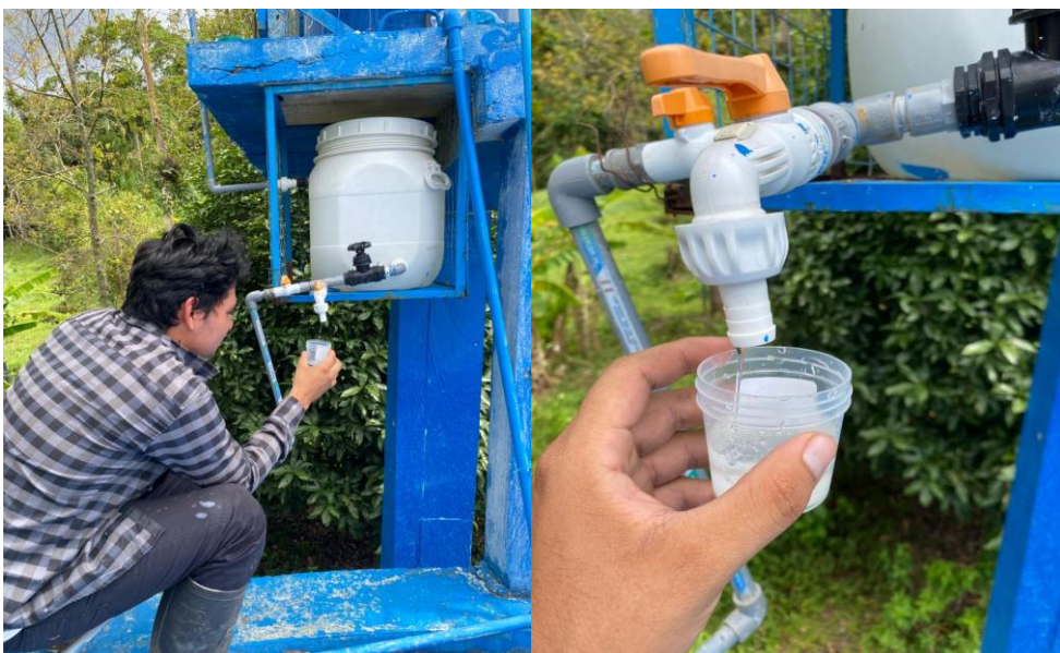
Figura 27 Calibración final del sistema de cloración
