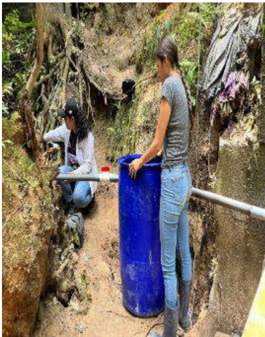
Fotografía 11. Instalación del sedimentador para la medición de concentraciones de parámetros en el afluente.
