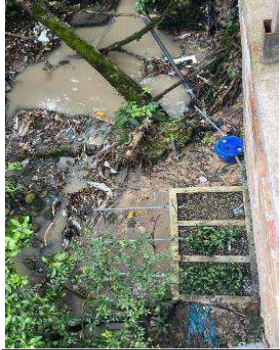
Fotografía 10. Vista de planta del sistema de tratamiento mediante humedales artificiales.
