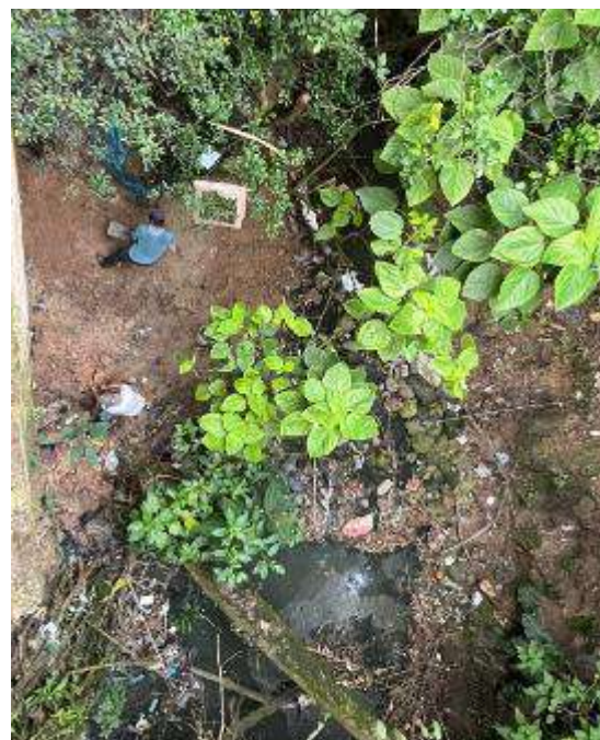
Fotografía 4. Limpieza del área para construcción del sistema de tratamiento mediante humedales artificiales.
