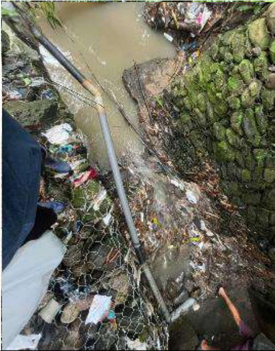
Fotografía 9. Captación de agua residual del sistema de tratamiento mediante humedales artificiales.
