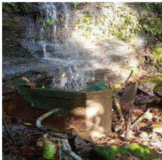
Fotografía 2. Captación de agua para consumo humano del centro poblado La Libertad del Bajo Mayo.
