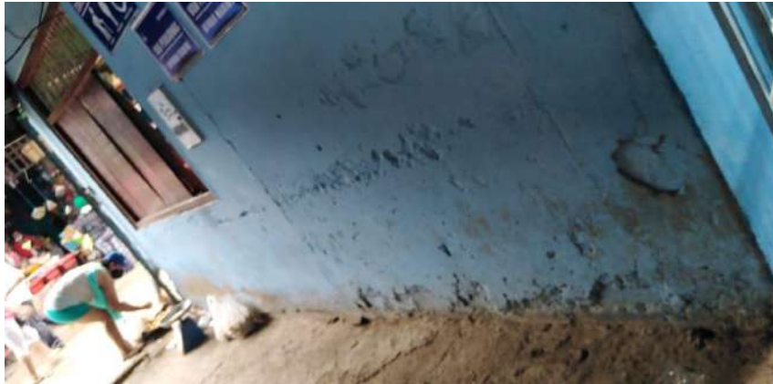
Muros agrietados que necesitan mantenimiento.
