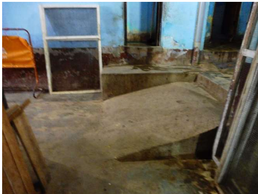
Rampa que no cumple con la normativa de accesibilidad.
