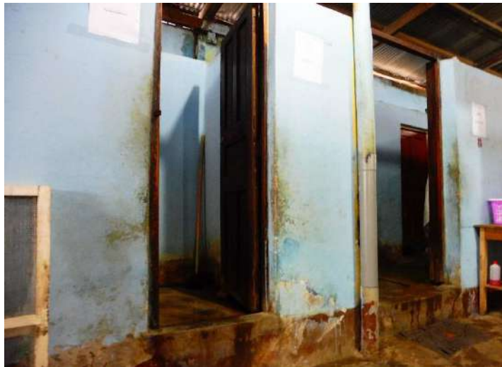
Los baños presentan Moho en techos, y es notable la falta de higiene
