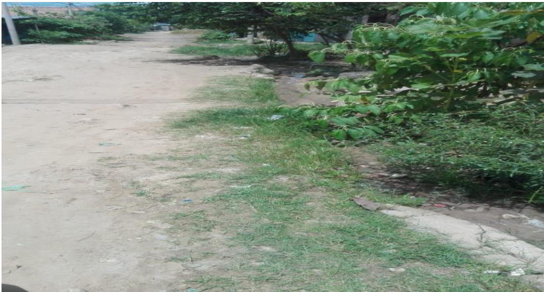
Figura A-02. En la imagen se aprecia una cuneta construida empíricamente por los pobladores ubicado en el jirón Los Flamencos C-02. ( Fuente: Elaboración propia)
