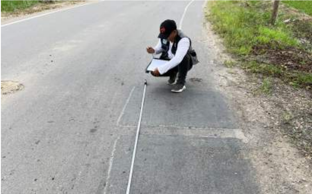
Foto 9: Falla de Parcheo de baja severidad
