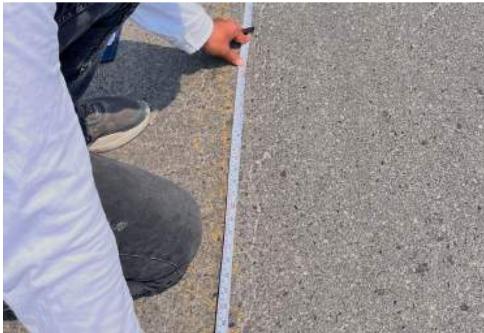
Foto 8: Falla de grieta longitudinal de baja severidad
