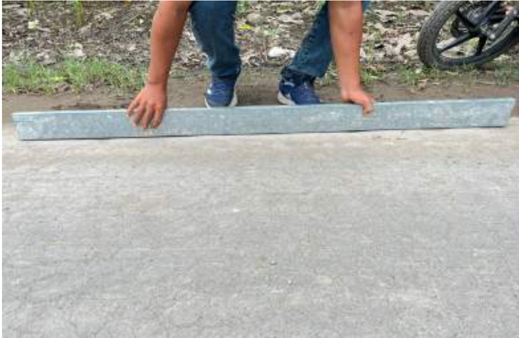
Foto 6: Falla de corrugación de baja severidad
