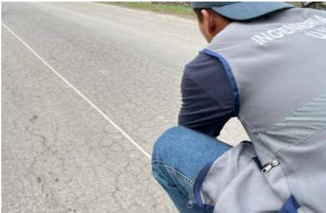
Foto 4: Medición de falla Piel de cocodrilo
