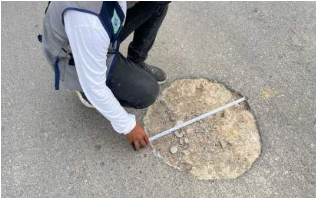
Foto 10: Falla de Huevo de severidad media
