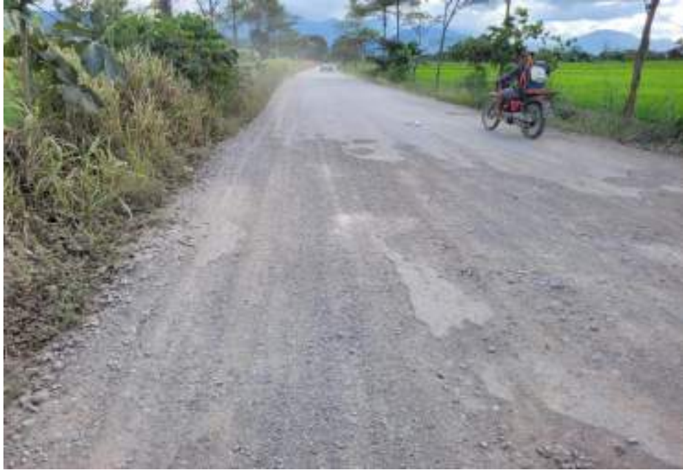
Foto 11: Falla de desprendimiento de agregados de alta severidad
