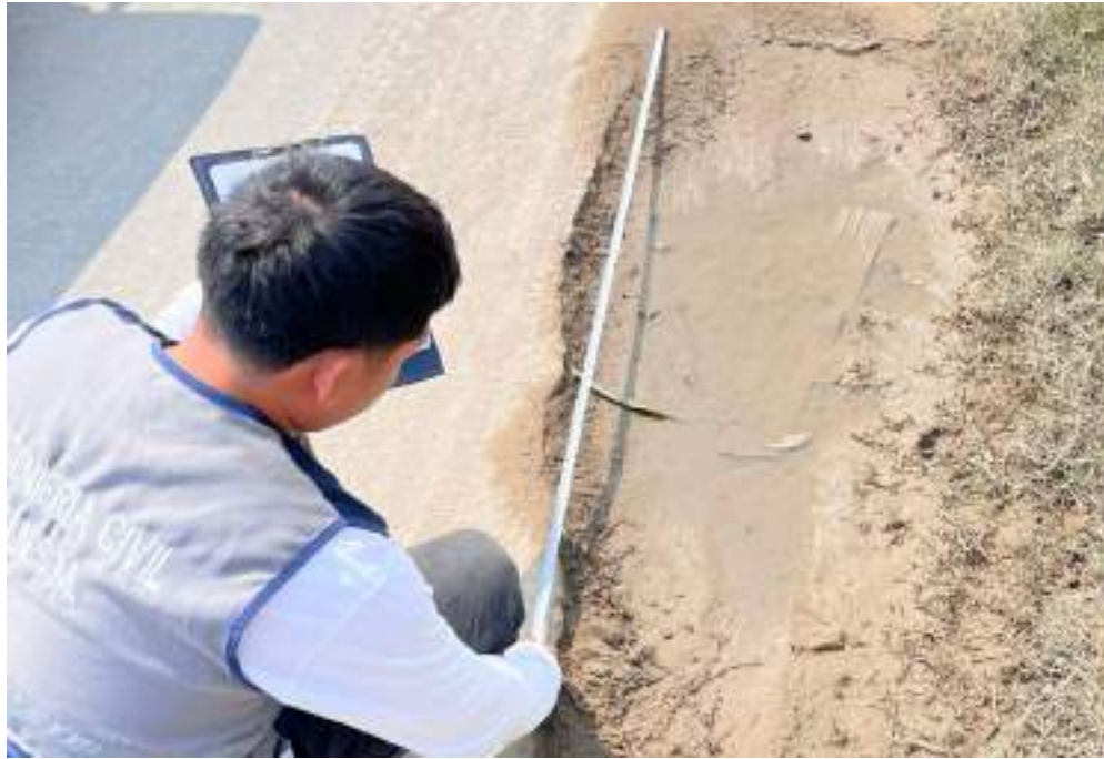
Foto 7: Falla de grieta de borde de alta severidad
