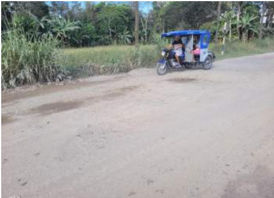
Foto 13: Sector 10 sin rastro de pavimento
