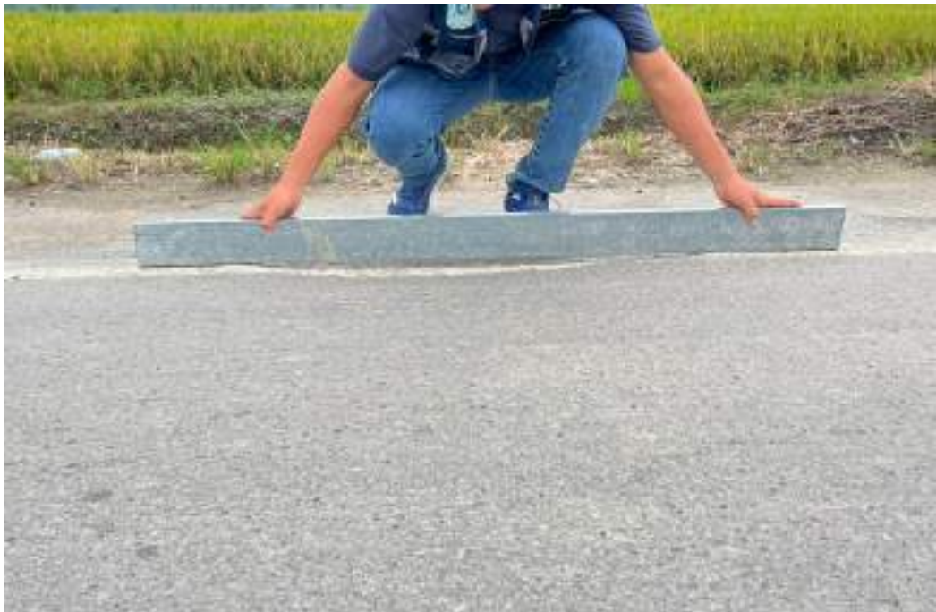
Foto 5: Falla de Depresión de severidad media
