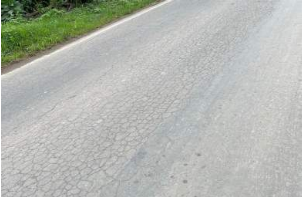
Foto 3: Falla Piel de cocodrilo de baja severidad
