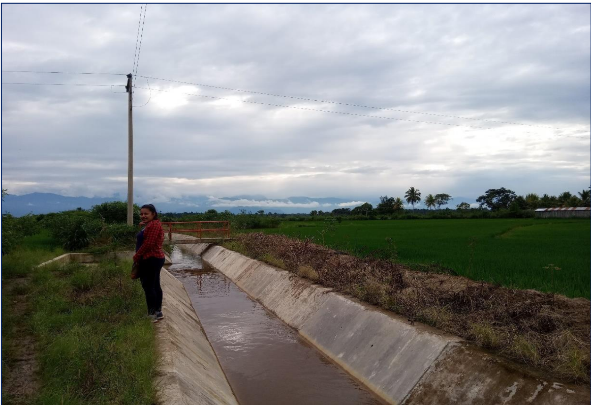
Figura 15. Canales de regadío.
