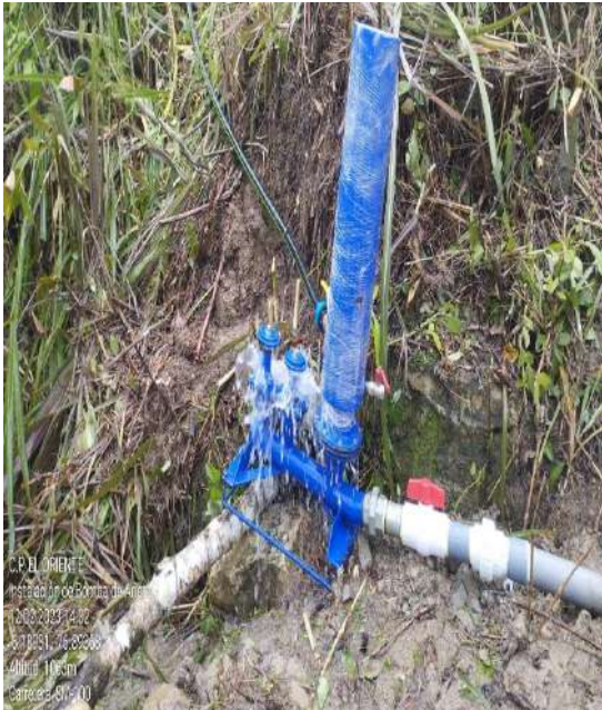
Fotografía 5. Bomba de ariete hidráulico instalado como parte del sistema de abastecimiento de agua.
