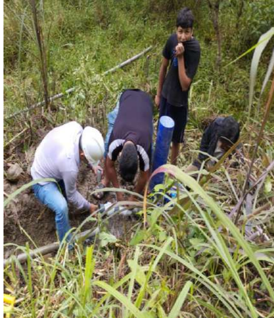
Fotografía 4. Instalación de la bomba de ariete hidráulico con la participación de la población.
