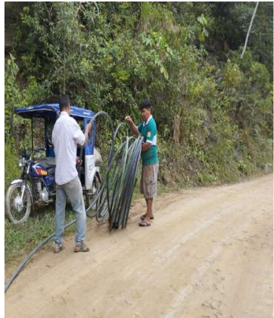
Fotografía 6. Instalación de manguera HDPE para conducir el agua desde la BAH hasta el reservorio.
