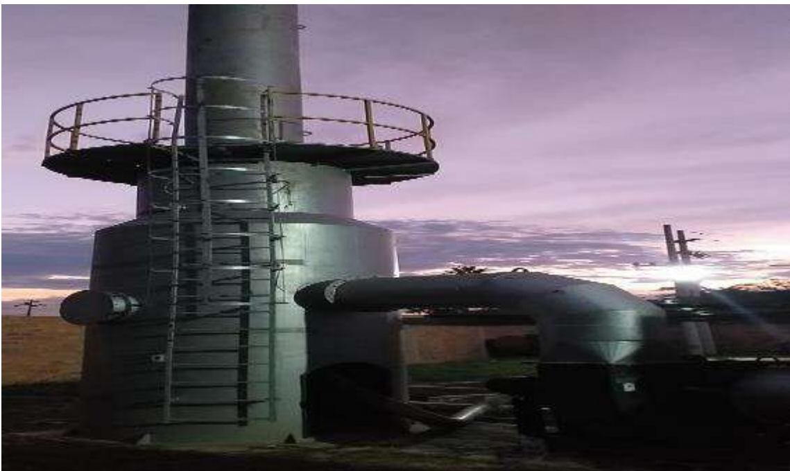
Figura 5 Extractor de gases y chimenea.
