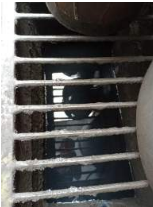
Ilustración 1. vertido de aceites en la alcantarilla
