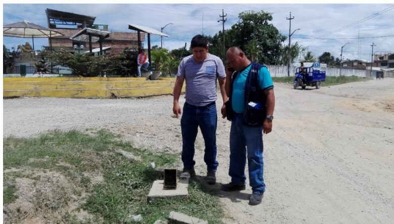
Foto N° 05: Se verifica y se identifica las diferentes válvulas de compuerta en las Redes de Distribución.
