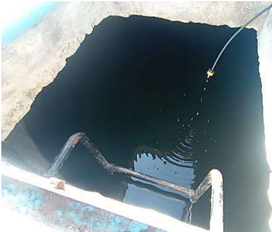
Fotografía 2. Caudal de goteo de solución de hipoclorito de calcio al reservorio
