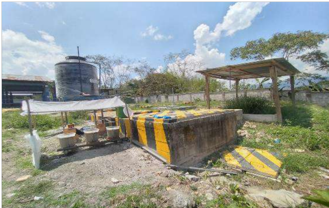
Fotografía 5. Sistema de filtro de piedra pómez instalado en el camal municipal.
