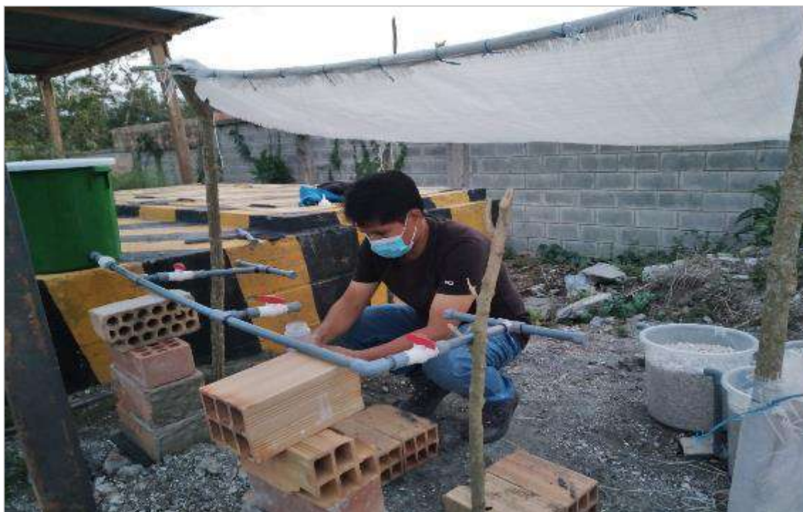
Fotografía 4. Medición de caudal de ingreso a los filtros de piedra pómez.
