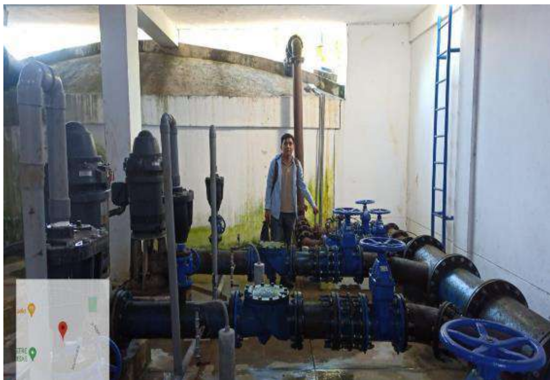
Fotografía 2. Cuarto de bombas de la línea de impulsión.
