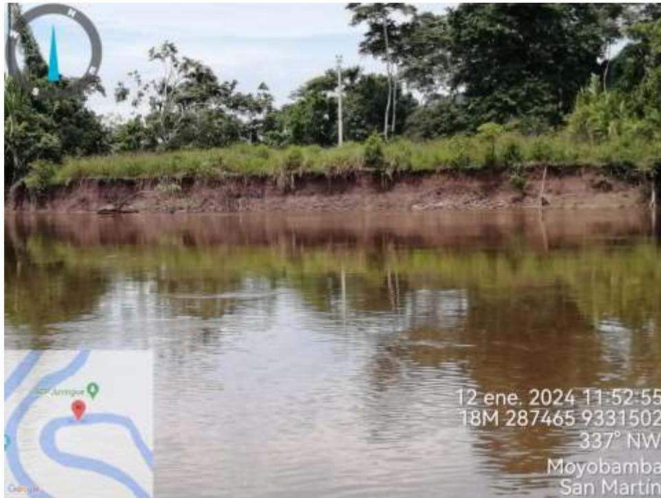
Fotografía 2. Identificación de puntos de erosión.
